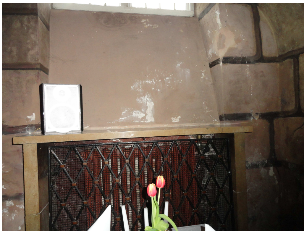
Fot. nr 12 Ślady wilgoci - wykwity solne.
