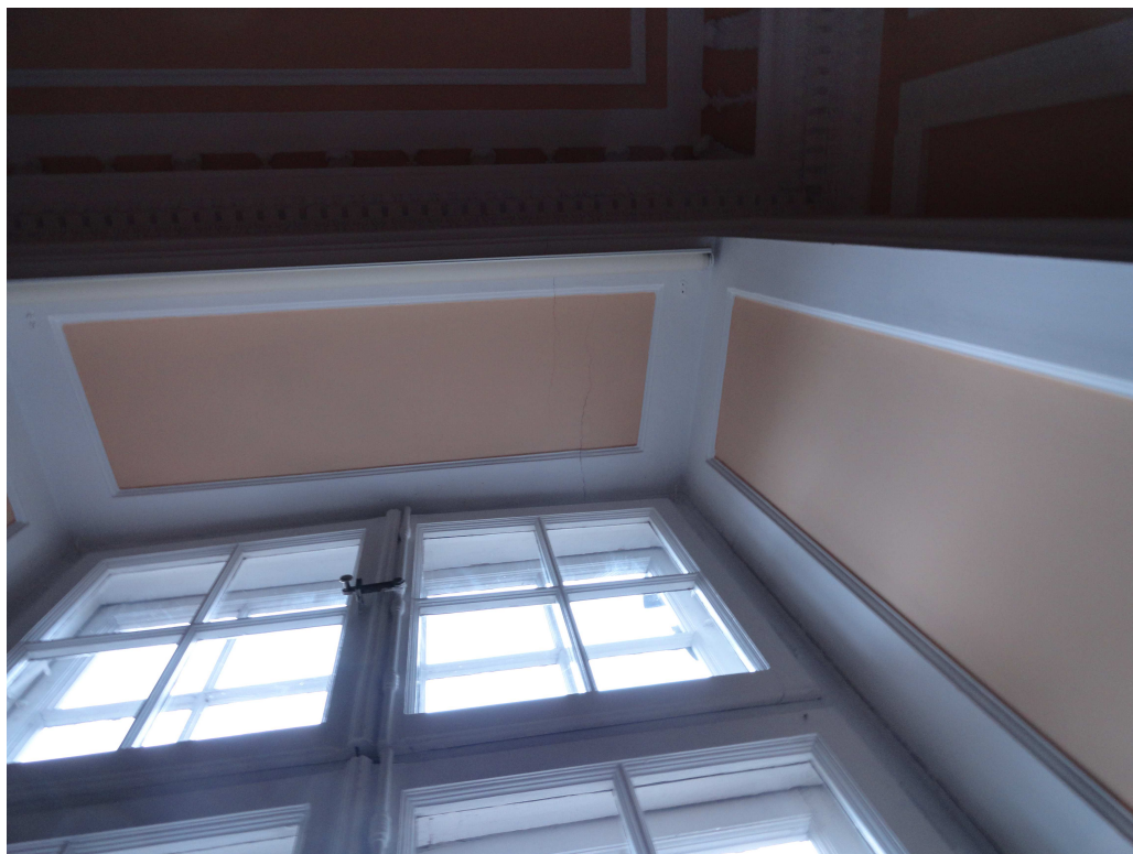
Fot. nr 2 Zarysowania nadproża od wewnątrz.
