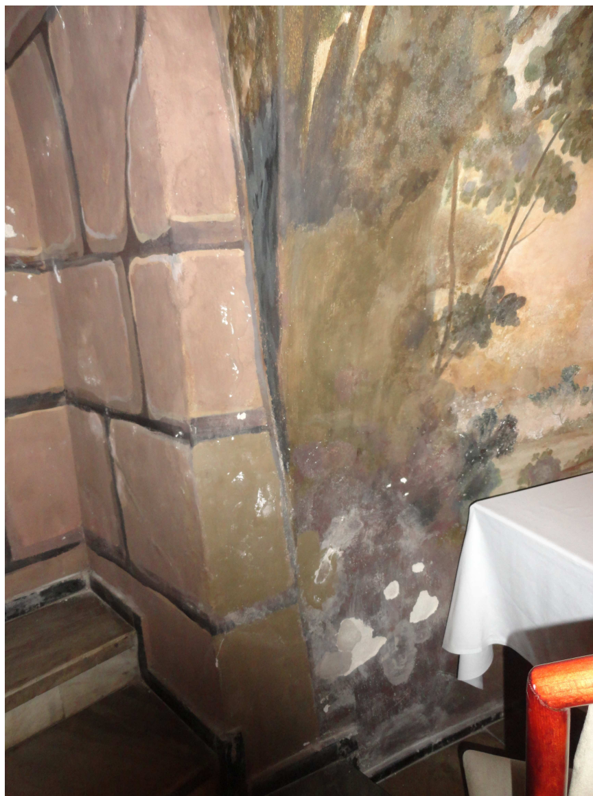
Fot. nr 13. Ślady wilgoci - odspojona od podłoża powłoka z farby.
