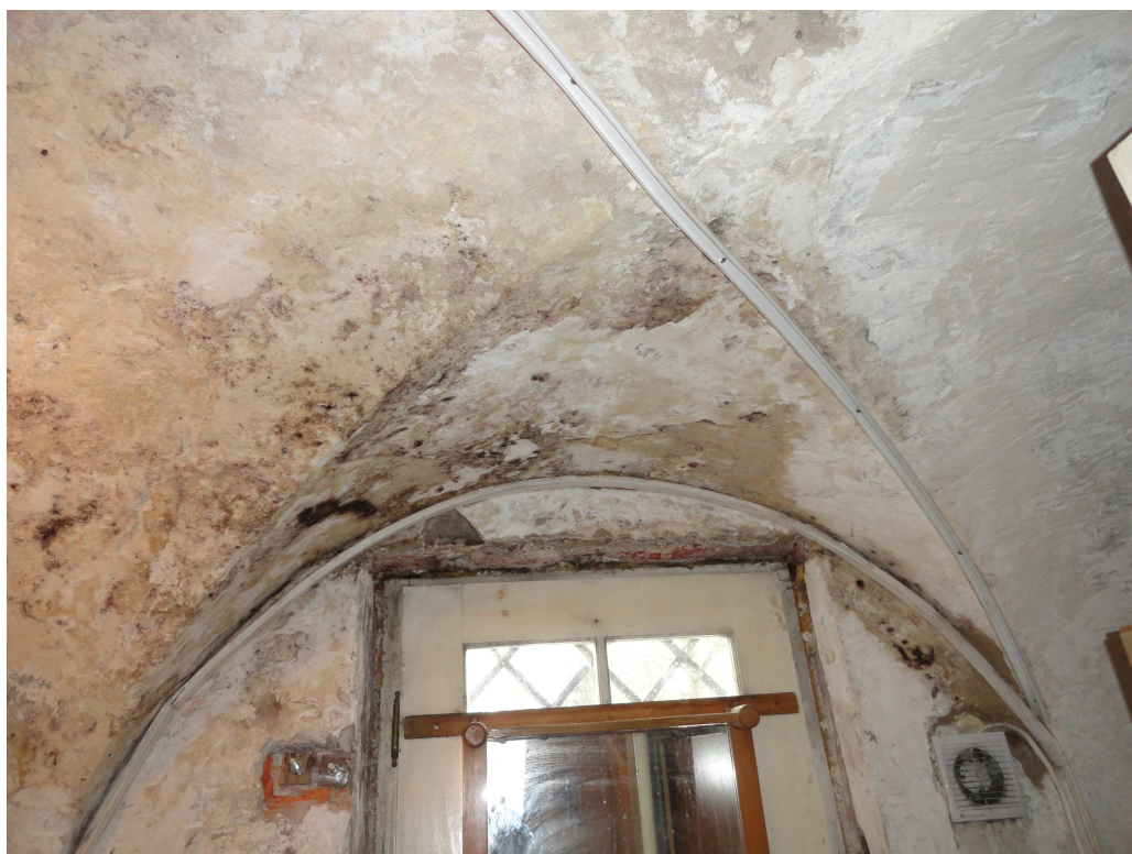
Fot. nr 4 Wykwity na ścianach i sklepieniu w piwnicy pod tarasem środkowym.
