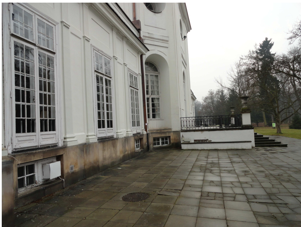
Fot. nr 6 Cokół pałacu i plac wyłożony płytami. Widoczne zniszczenia płyt.
