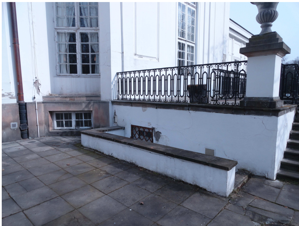
Fot. nr 7 Cokół pałacu, ściana tarasu i płyty placu. Widoczne liczne spękania na ścianie tarasu.
