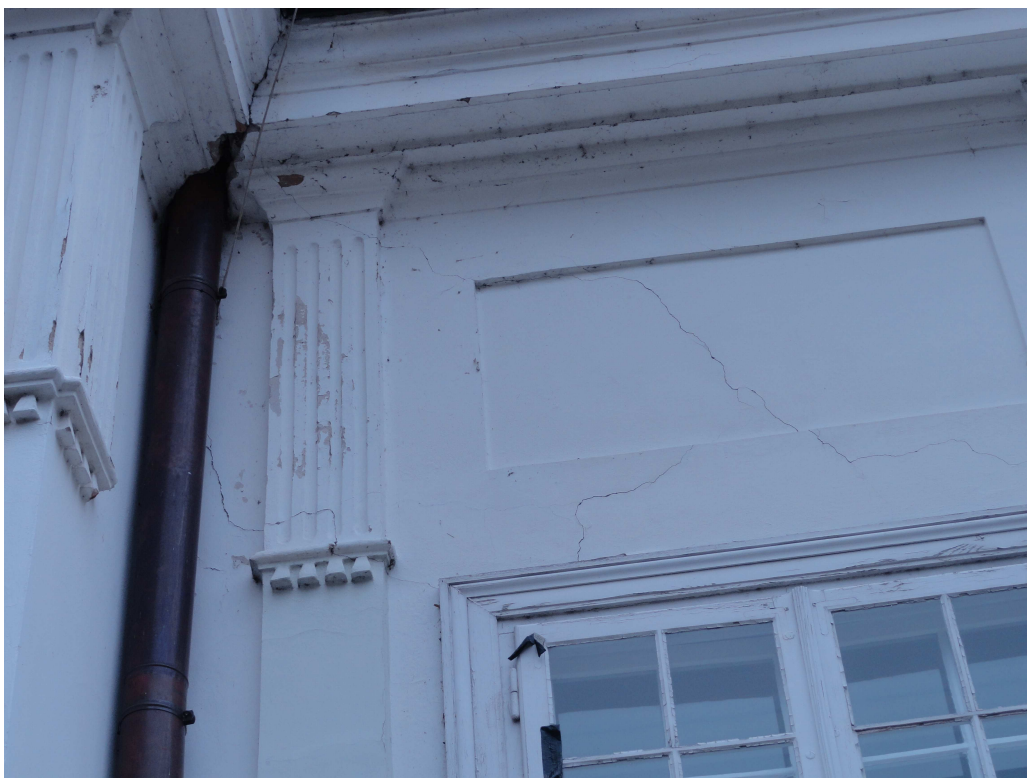
Fot. nr 1 Zarysowania ściany kondygnacji parterowej.
