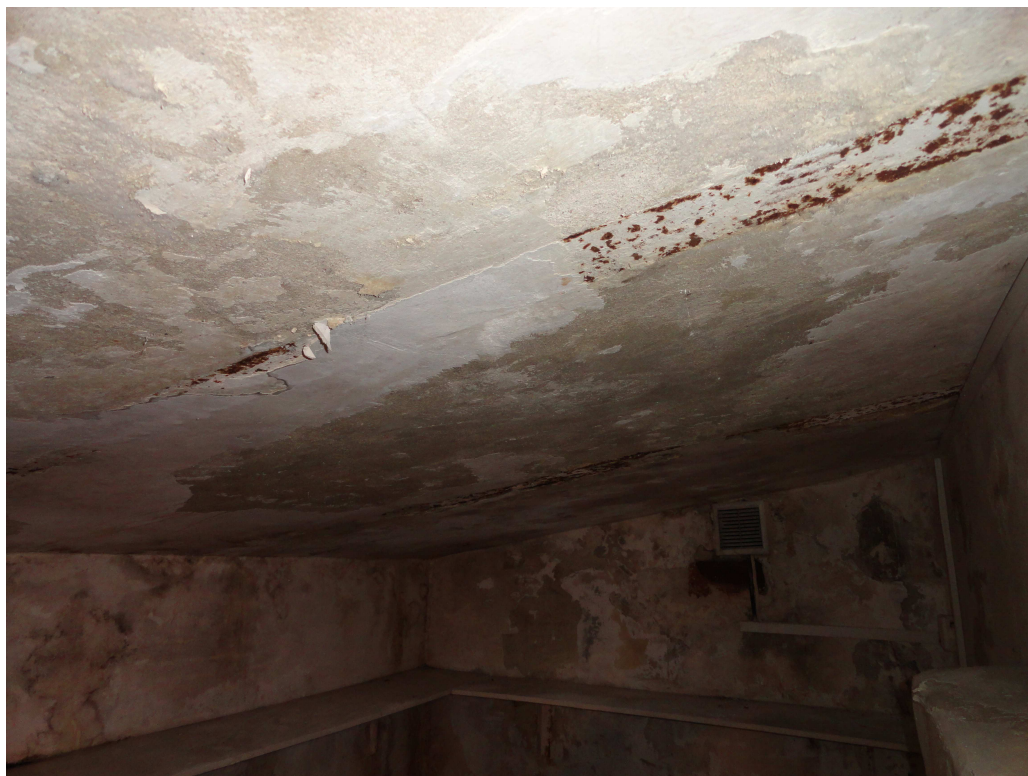
Fot. nr 11 Pomieszczenie pod tarasem z płytą kleina. Widoczne ślady obfitych zacieków w postaci wykwitów.
