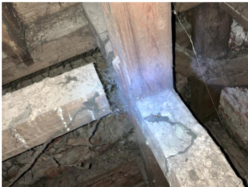
Fot. 8. Węzeł wymagający naprawy
