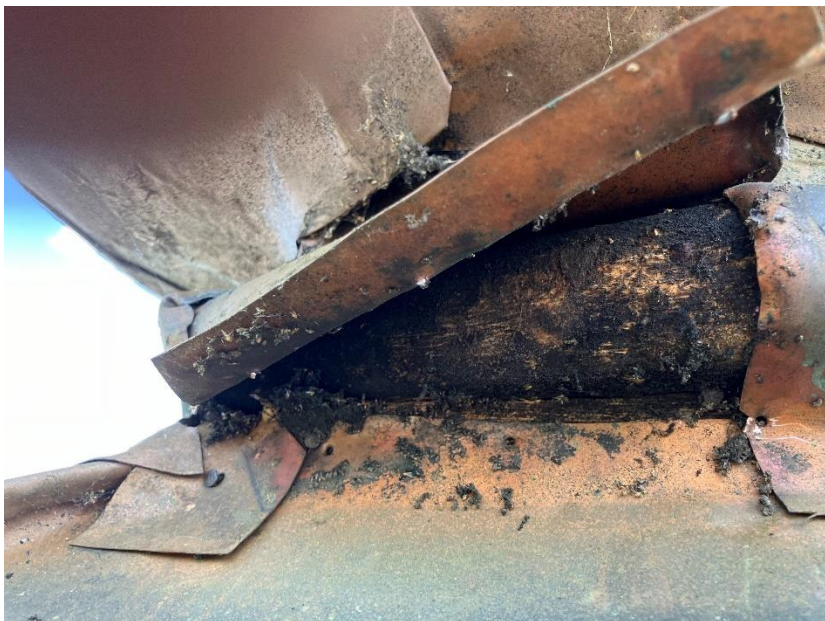
Fot. 3. Miejsce połączenia kuli z dachem. Widoczne zanieczyszczenia pod blachą
