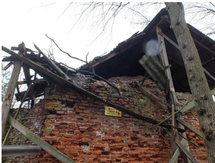
Fot. 6. Północna ściana muszli. Widoczna zawalona połać wiaty oraz ubytki w murze.
