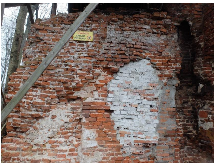
Fot. 3. Zachodnia ściana muszli. Widoczne przemurowanie otworu z cegły współczesnej oraz zawalony komin.
