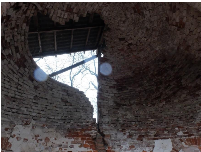
Fot. 5. Sklepienie z widoczną zawaloną częścią. Widoczne także pęknięcie przechodzące w ścianę północną.
