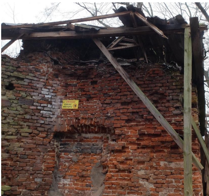
Fot. 2. Wschodnia ściana muszli. Widoczny zamurowany otwór oraz liczne ubytki w cegłach.
