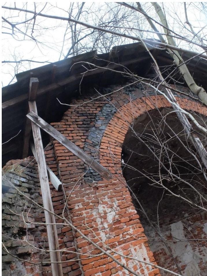
Fot. 1. Łuk arkady wraz z lewym filarem. Widoczna pionowa rysa oraz pozostałości tynku.
