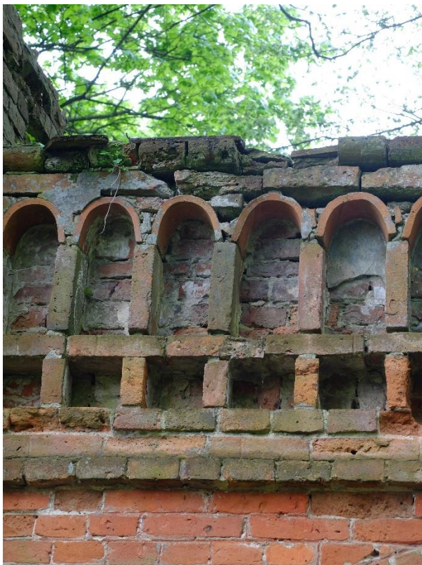
Fot. 1. Widok fragmentu okapu oraz fryzu- widoczne ubytki cegieł, dachówki oraz tynków wewnątrz fryzu
