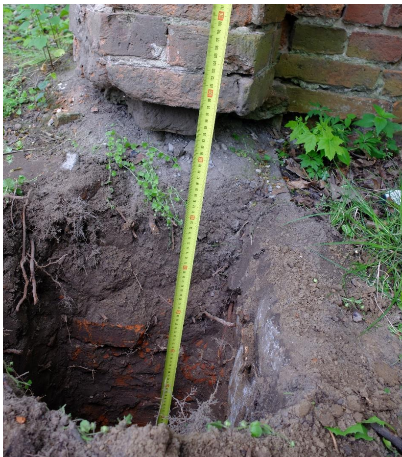
Fot. 11. Fundament filara wolnostojącego. Widoczna warstwa ziemi wypełniająca ubytek w filarze.
