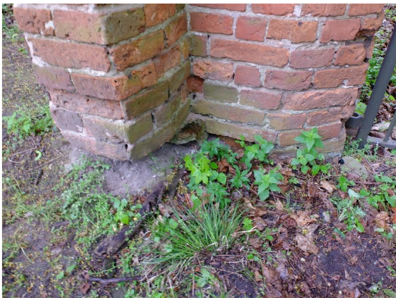
Fot. 4. Uszkodzenie filara bramy przy gruncie wymagające podmurowania od wierzchu fundamentu
