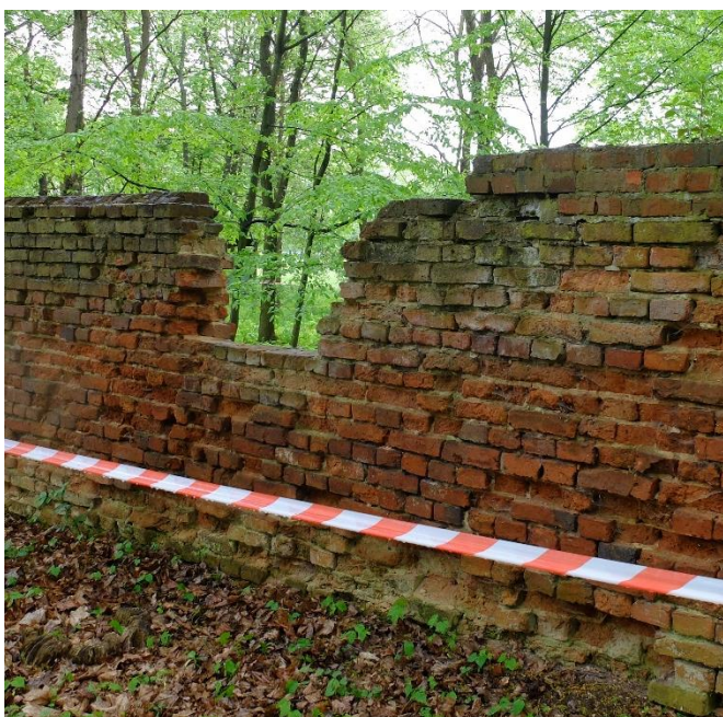
Fot. 7. Wyrwa w murze
