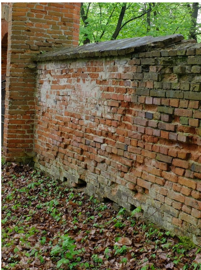
Fot. 6. Fragment muru od strony bramy z zachowanym okapem. Widoczne liczne ubytki cegieł.
