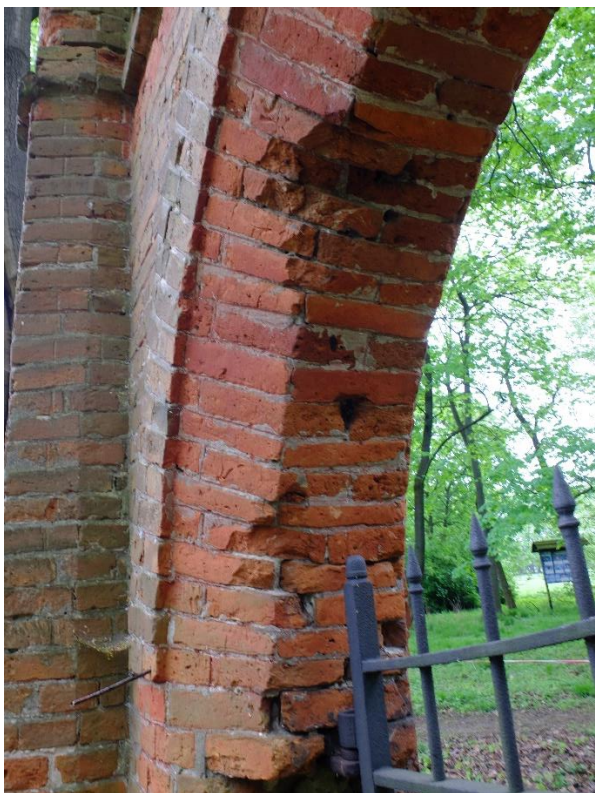
Fot. 2. Fragment łuku z widocznym ubytkiem
