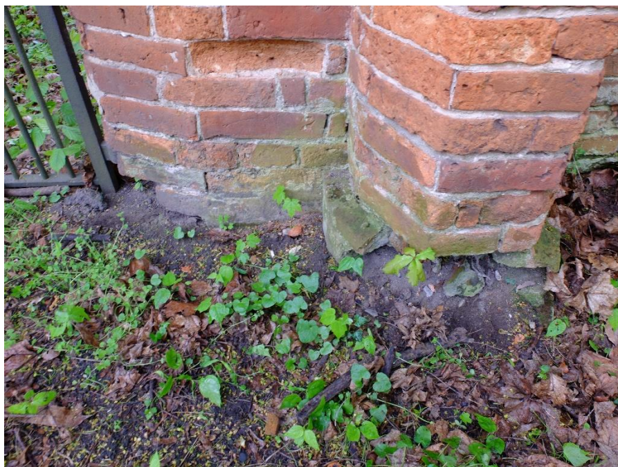
Fot. 5. Uszkodzenia drugiego filara bramy (od strony muru) wymagające podmurowania od wierzchu fundamentu
