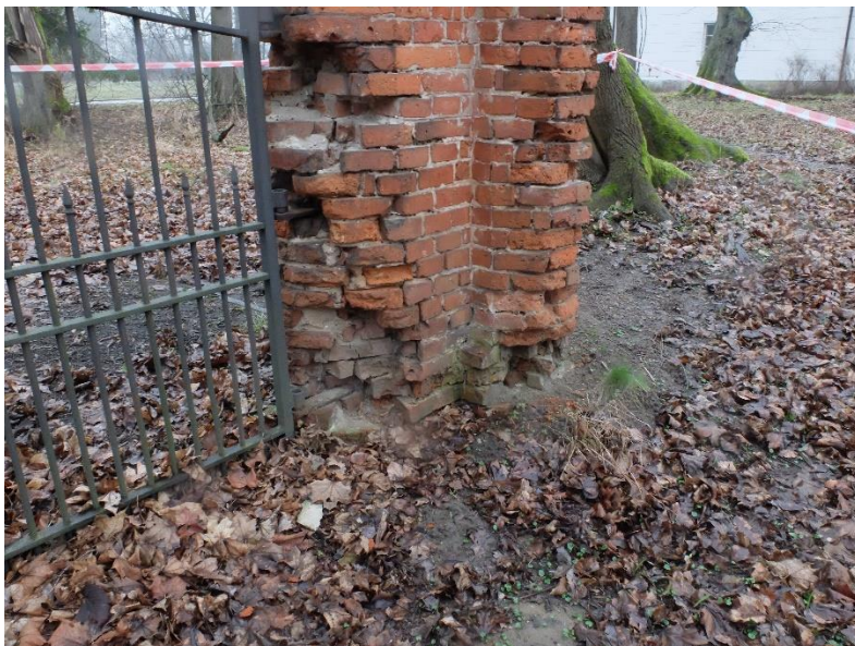
Fot. 3. Uszkodzenia filara bramy w pobliżu zawiasów wymagające przemurowania
