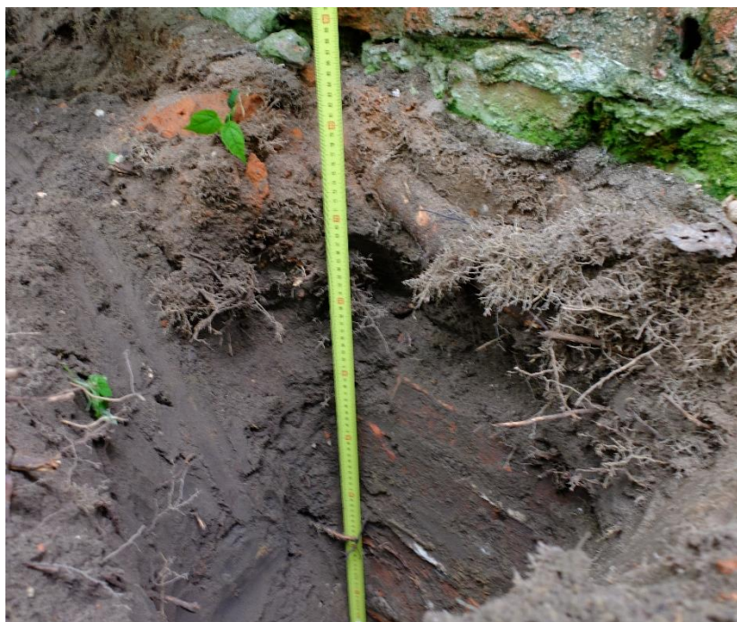
Fot. 12. Fundament muru. Widoczne korzenie drzewa oraz mchy i glony na ścianie muru.
