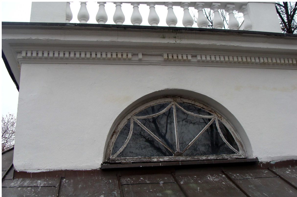
Fot. 12. Uszkodzenia gzymsu wieńczącego „belwederek”
