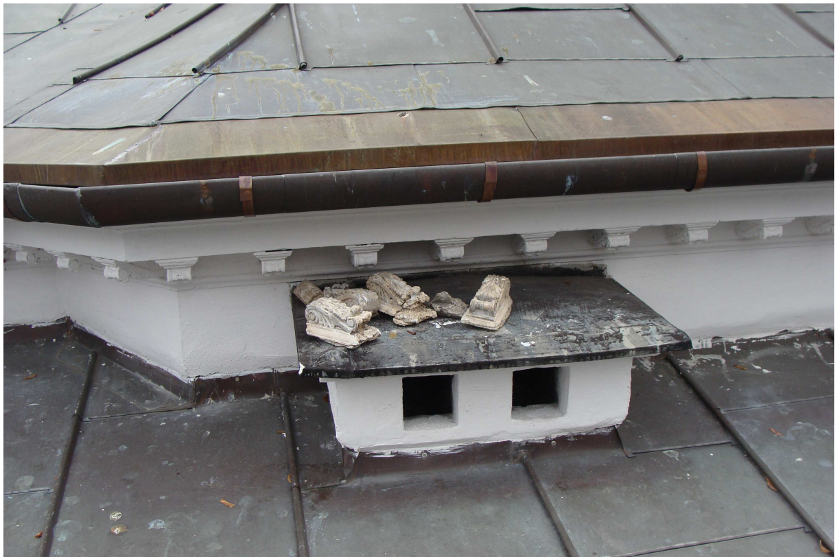
Fot. 11. Zniszczenia elementów sztukatorskich (kroksztynki) gzymsu wieńczącego
