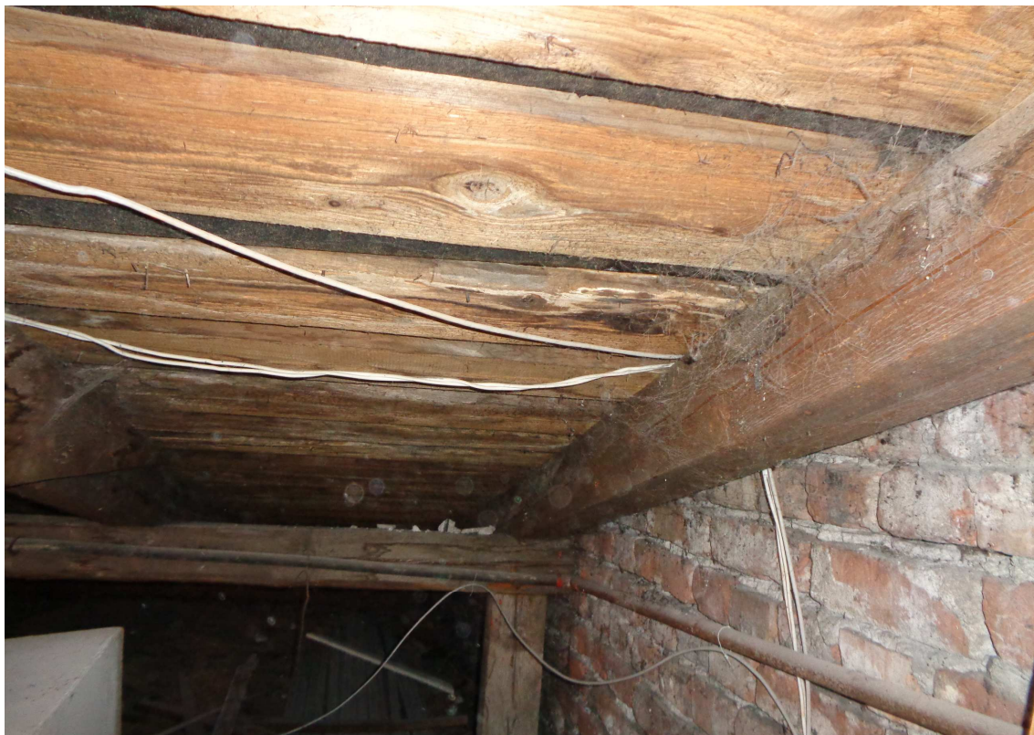
Fot. 29. Dach G – zawilgocenia deskowania i krokwi
