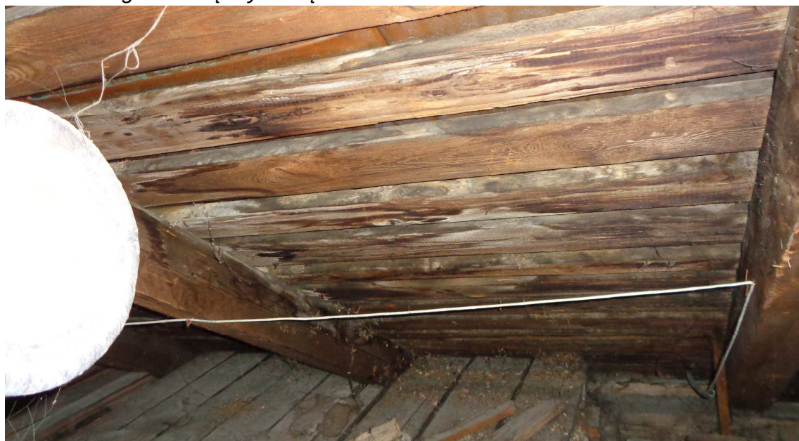
Fot. 16. Zawilgocenia poszycia dachu nad lukarną
