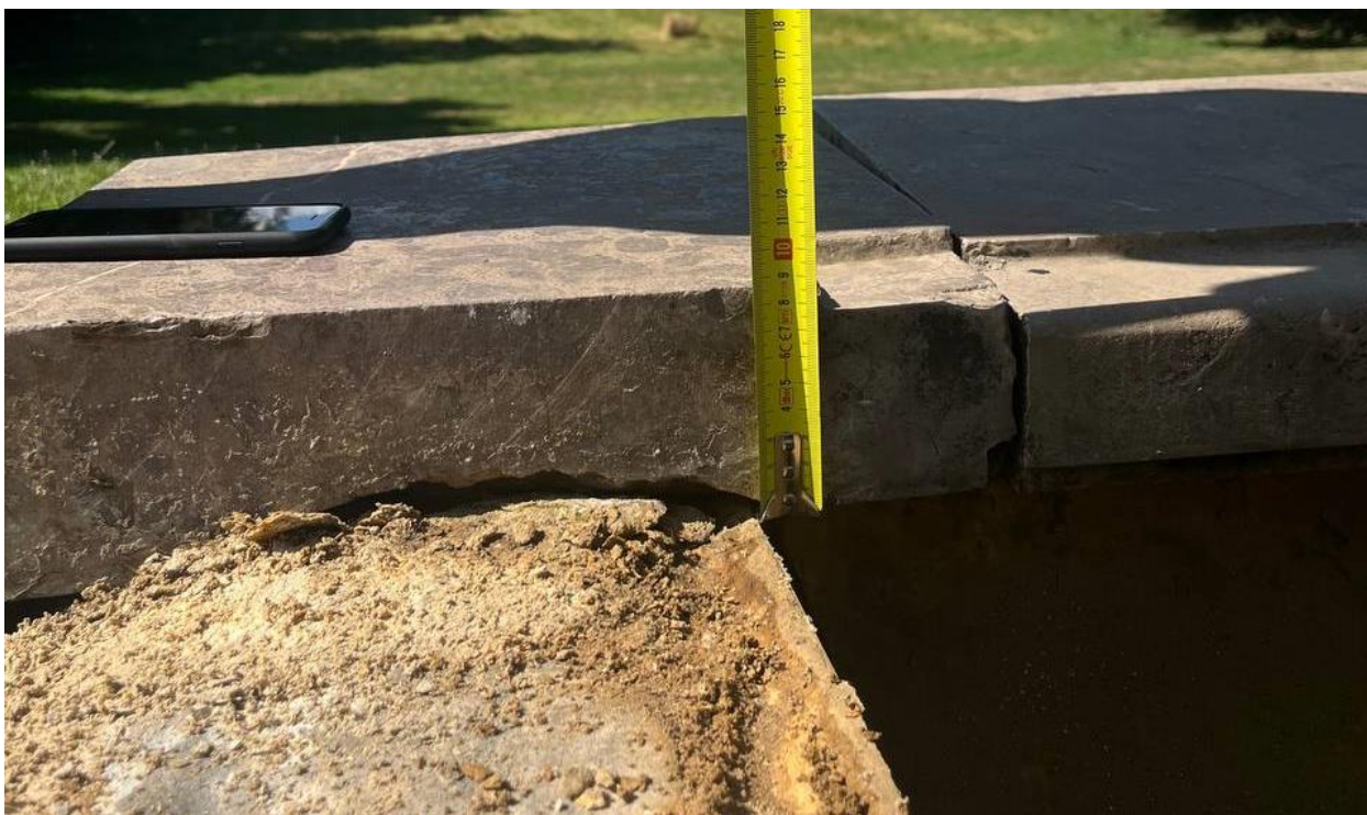
Fot. 3. Zwieńczenie muru- gzyms po zdjęciu jednego elementu
