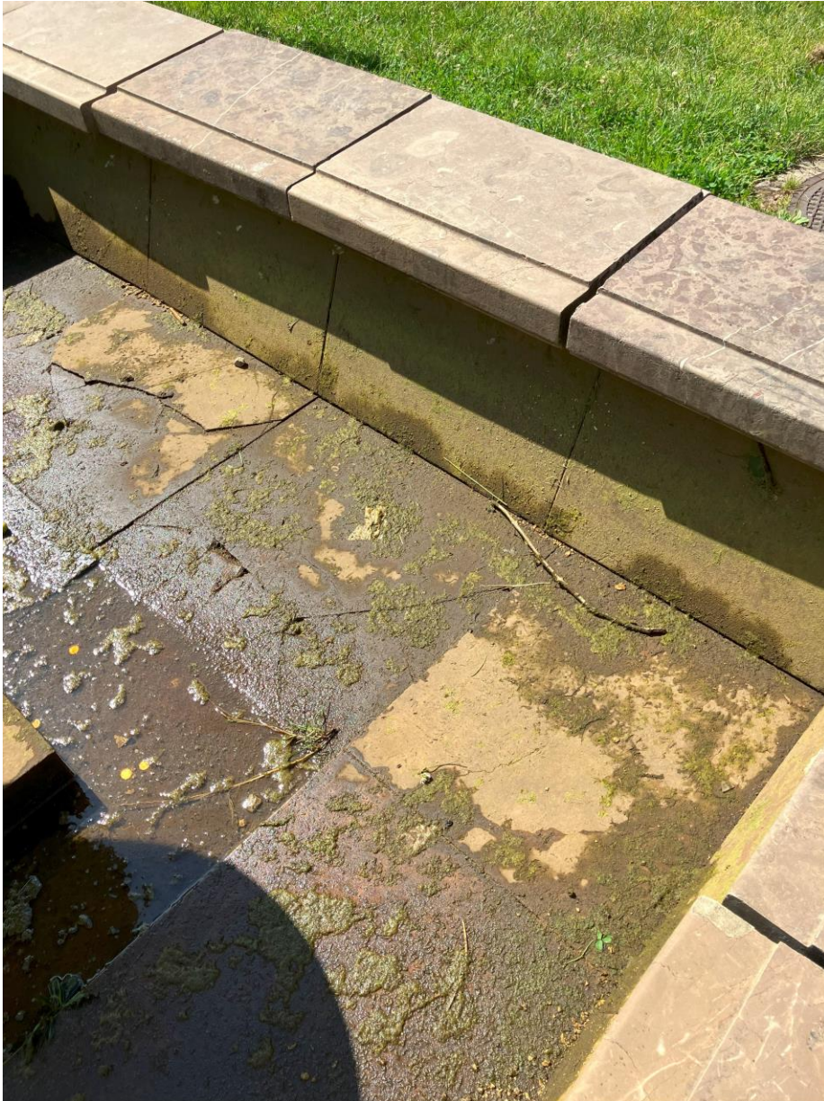
Fot. 6. Posadzka basenu fontanny- widoczne spękania oraz zapadnięcia płyt.
