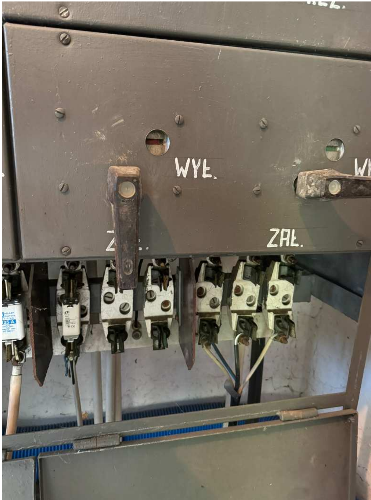
Istniejący agregat prądotwórczy
