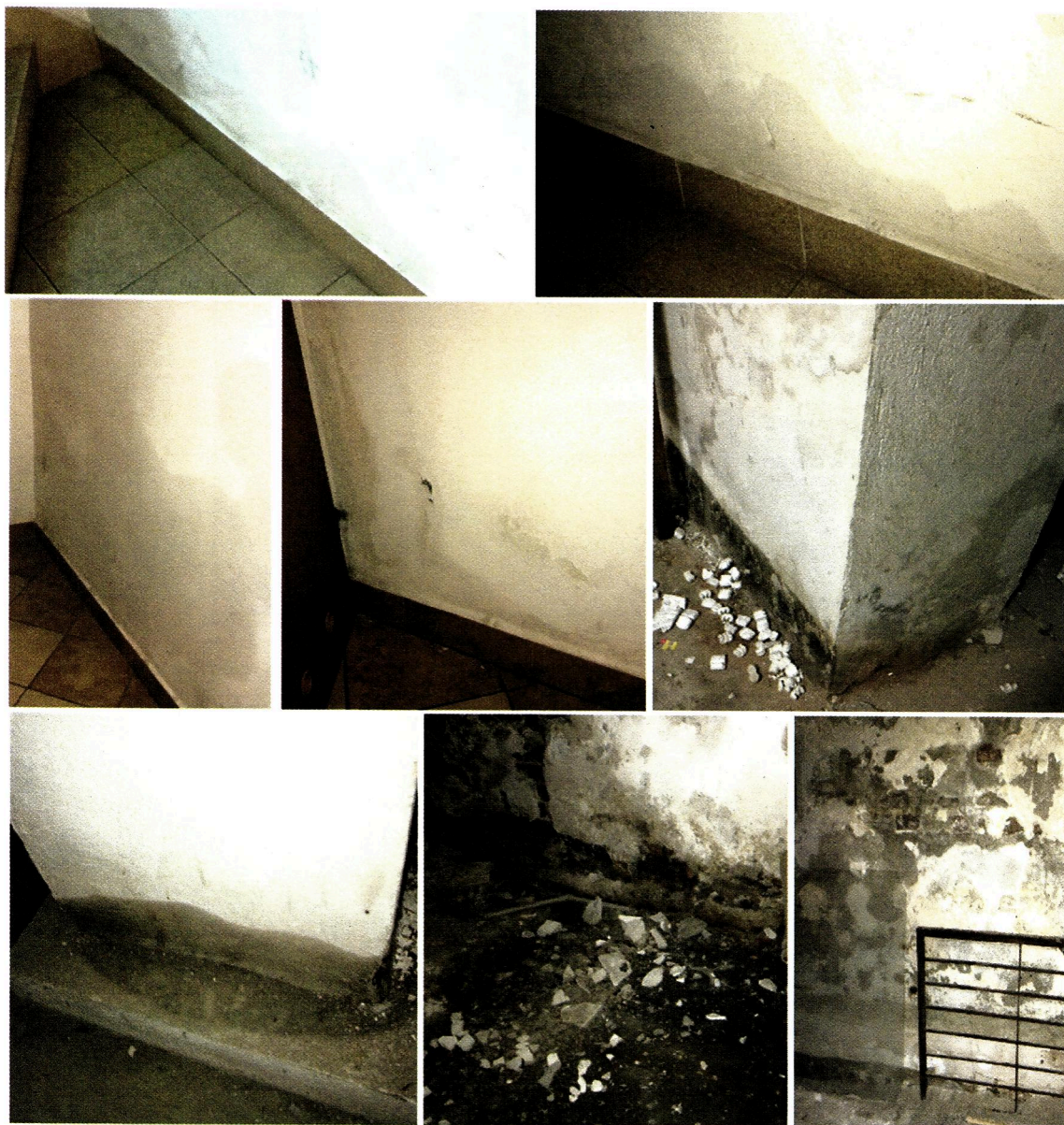
Fot. nr 36. Przykład zawilgoczeń ścian podziemia budynku
