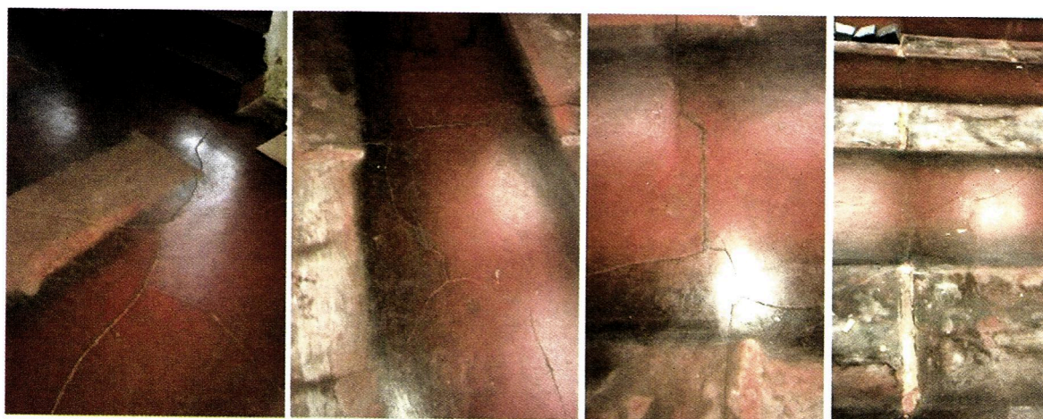
Fot. nr 41. Przykład zarysowania posadzki w stropie nad piwnicą
