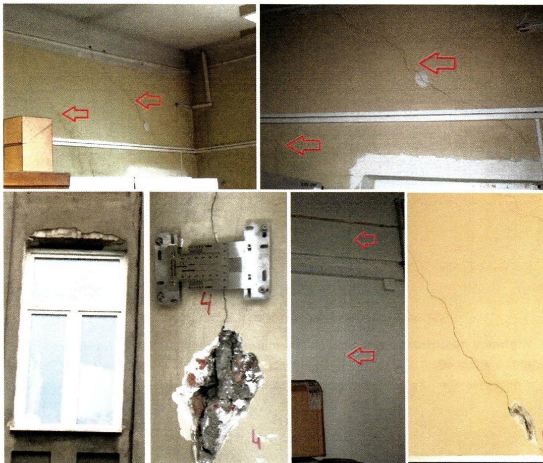
Fot. nr 38. Przykład zarysowań ścian nośnych budynku
