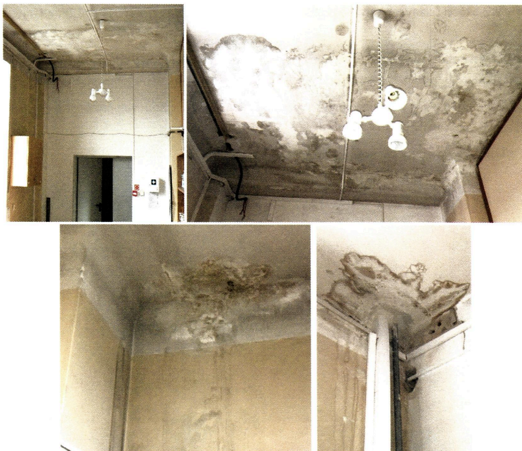
Fot. nr 37. Przykład śladów po przeciekach na stropach wewnątrz budynku
