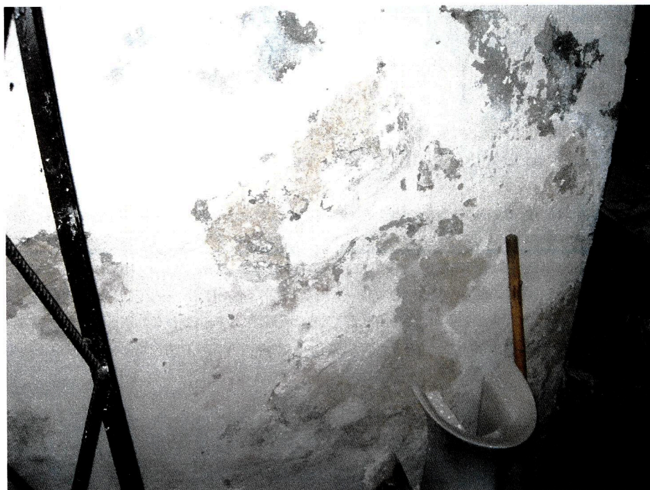
Fot.13. Zawilgocona ściana zewn. piwnicy. Odpadający tynk i łuszcząca się farba.
