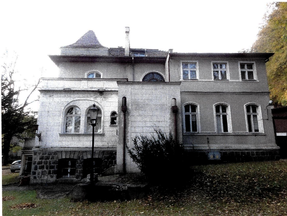
Fot.3. Elewacja północno-wschodnia. Widoczna łuszcząca się farba elewacyjna na skutek nieszczelności obróbek blacharskich i koszy spustowych.
