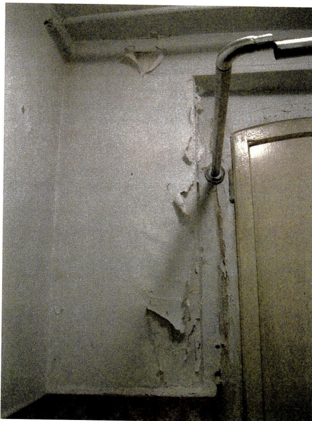
Fot.12. Zawilgocona ściana zewn. piwnicy. Odpadający tynk i łuszcząca się farba.
