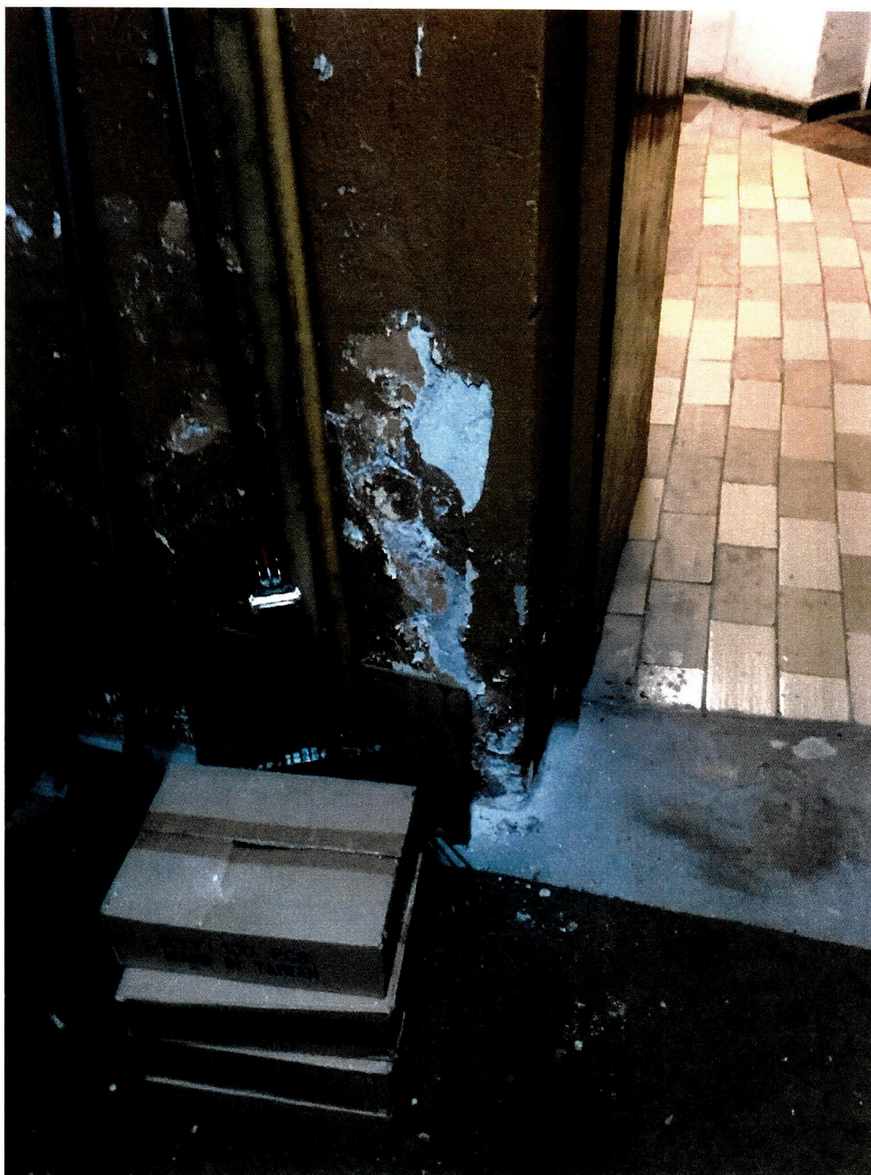
Fot.15. Zawilgocona ściana wewnętrzna i tynk piwnicy przy posadzce.
