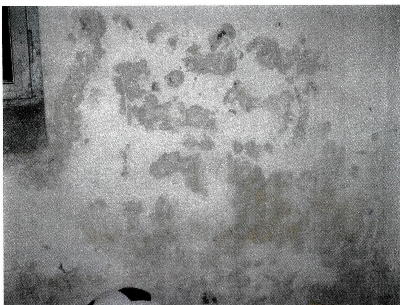
Fot.8. Zawilgocona ściana zewn. od strony elewacji północno-zachodniej.
