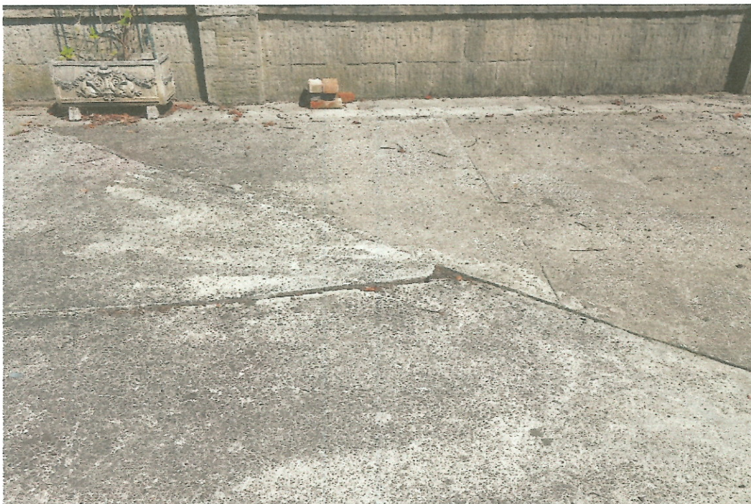
Fragment posadzki widoczne przemieszczenie elementów
