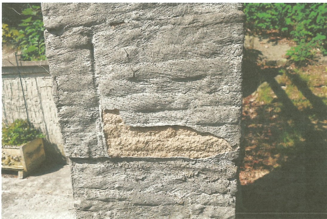
Fragment okładziny z betonowych kafli, zaciągniętej mlekiem cementowym
