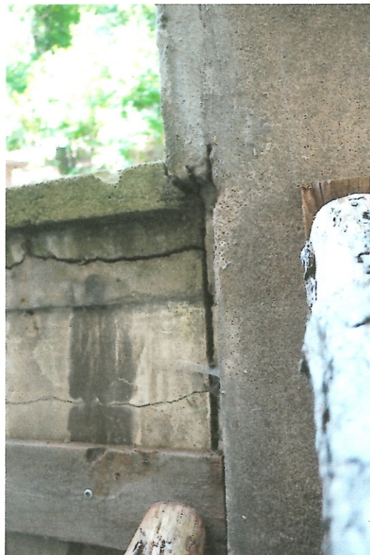
Rozspojone elementy w narożniku balustrady
