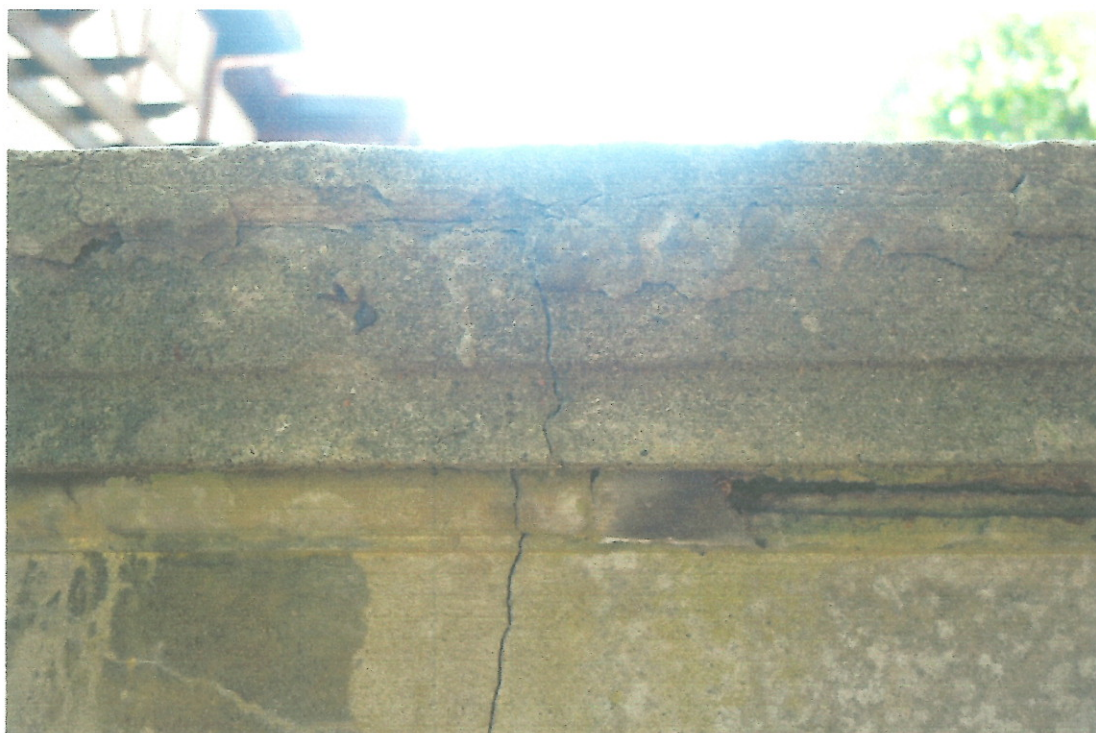
Nadlewka cementowa na wypłukanej nakrywie
