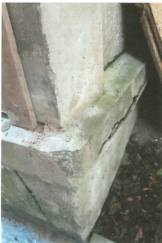
Uszkodzenia w narożniku pn. wsch.
