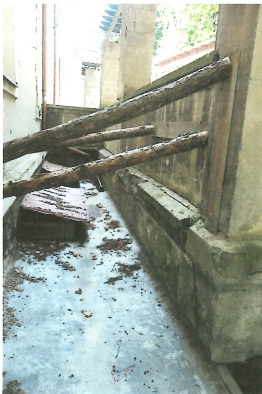
Widok na balustradę od strony elewacji tylnej Widoczne stemplowanie muru i ubytki
