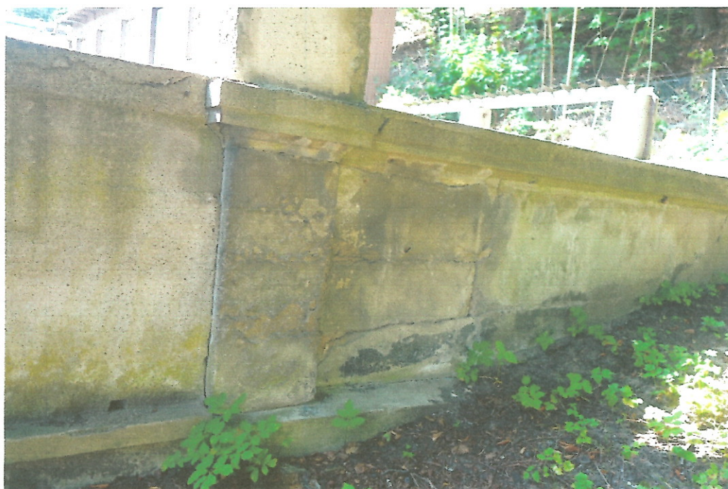
Wychylona, popękana i rozspojona balustrada po stronie wschodniej
