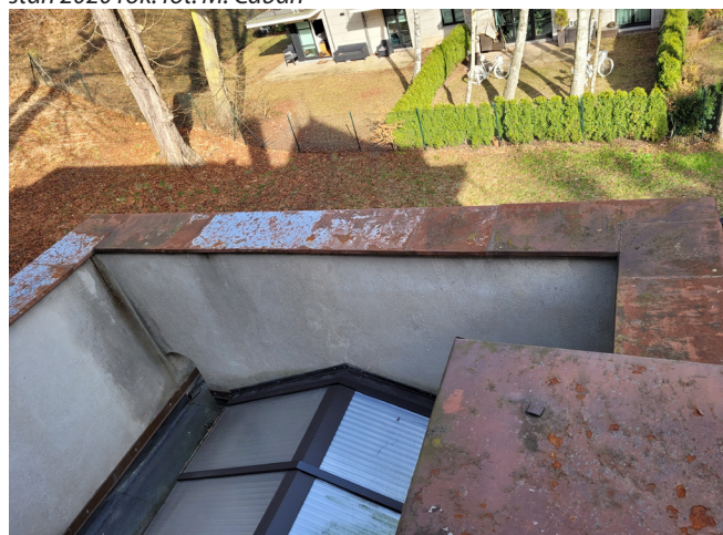
fot. 53. Ściana parawanowa nad świetlikiem wejścia głównego, widoczne skorodowane obróbki blacharskie i zaciekanie wody opadowej po licu muru, marzec 2021 rok. fot. M. Caban
