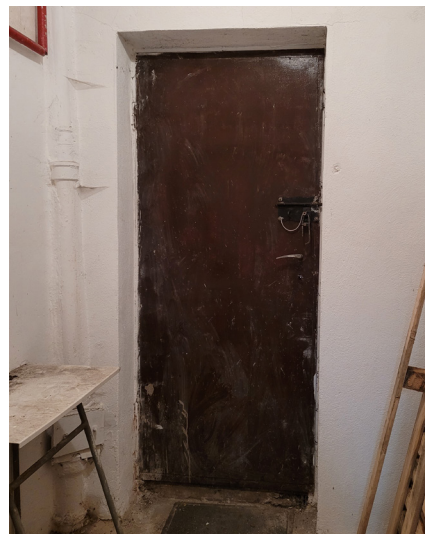
fot. 127. Ościerze drzwiowe nr P11 (widziane od wewnątrz), Metalowe drzwi kotłowni, należy ujednolicić kolorystycznie do całego projektu budynku. marzec 2021 rok. fot. M. Caban
