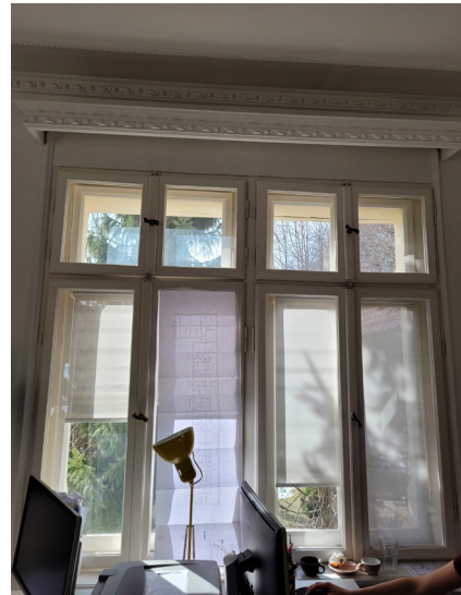
fot. 94. Ościeżce okienne nr 22 (widziane od wewnątrz), wszystkie warstwy malarskie zostały usunięte, stolarkę pomalowano wtórnie na biało. marzec 2021 rok. fot. M. Caban
