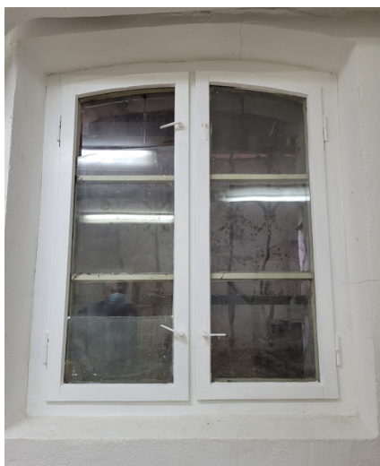
fot. 113. Ościeżce okienne nr P2 (widziane od wewnątrz), stolarka pomalowana na biało, okno w bardzo złym stanie - do wymiany, marzec 2021 rok. fot. M. Caban
