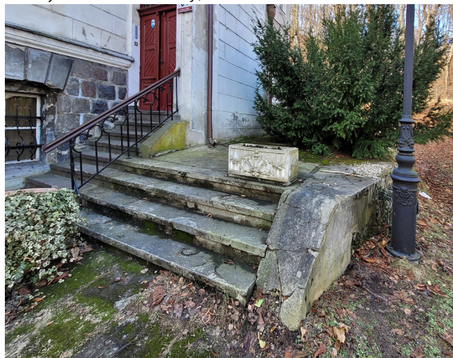
fot. 45. Zniszczone betonowe schody wejścia głównego
