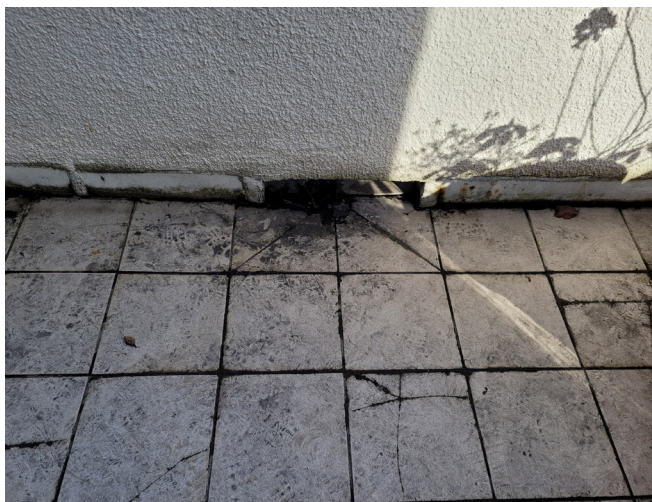
fot. 51. Odpływ tarasu bocznego, widoczne popękane kafle i silne skażenie mikrobiologiczne, marzec 2021 rok. fot. M. Caban
