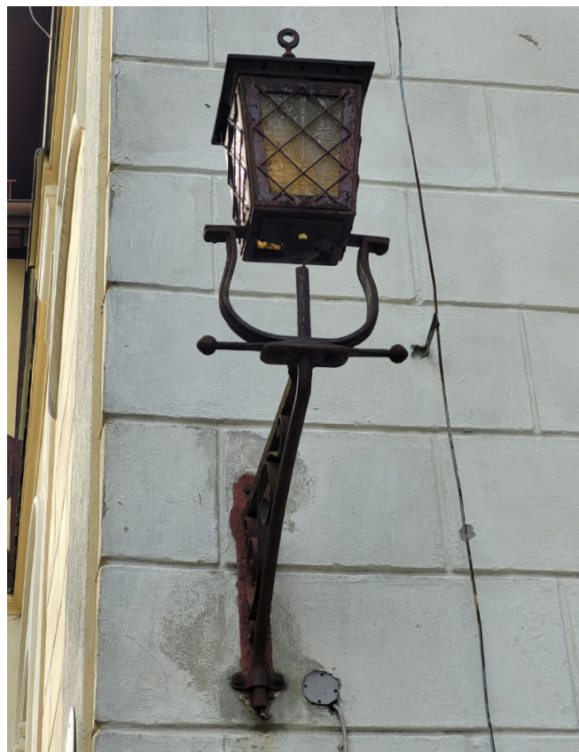
fot. 52. Zabytkowa lampa zamontowana na elewacji bocznej przy wejściu głównym, widoczne łuszczenie się farby i korozja metalu, stan 2020 rok. fot. M. Caban
