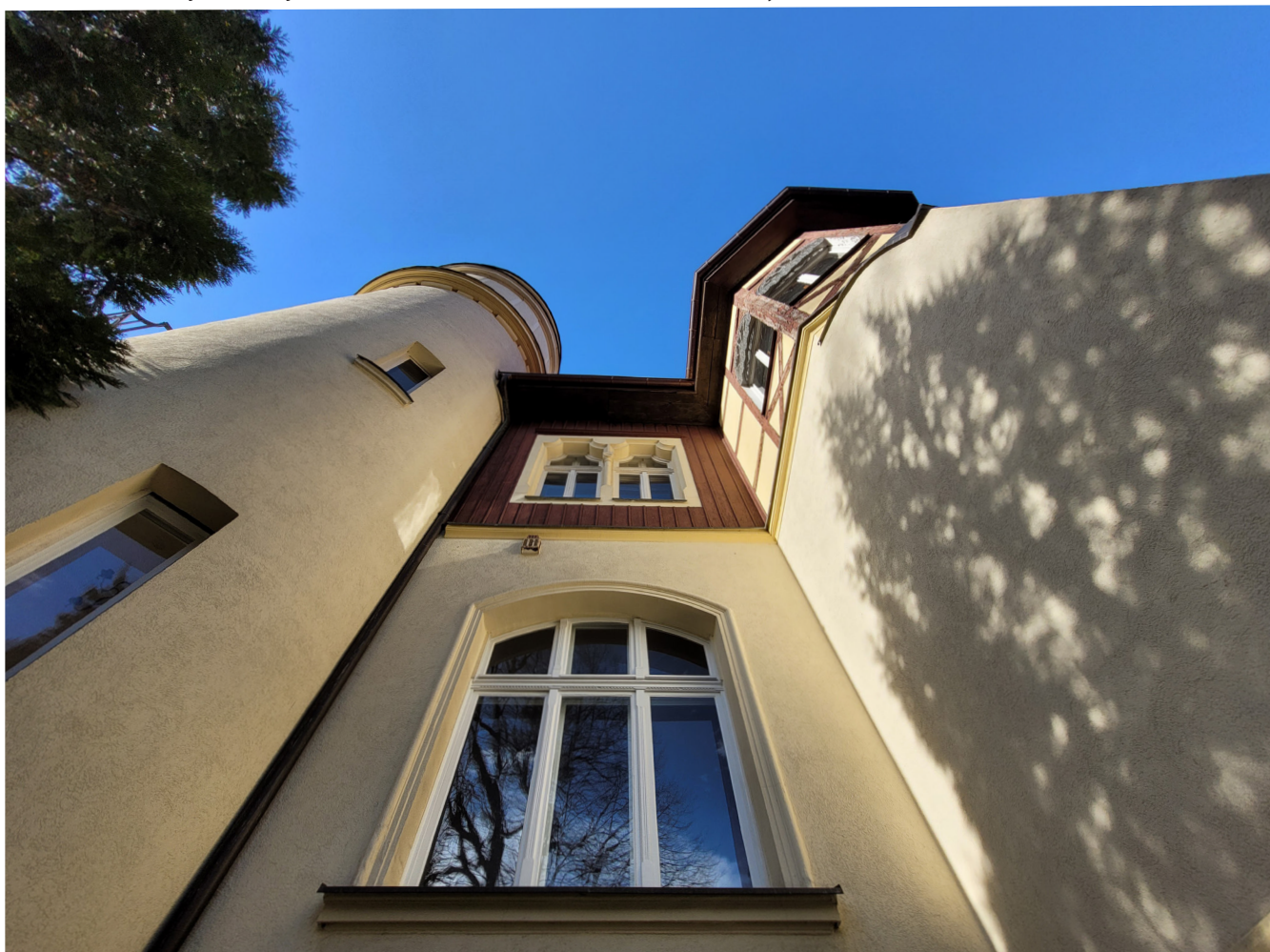
fot. 15. Elewacja frontowa wraz z wieżyczką, w oknach górnej kondygnacji założono wtórnie odeskowanie oraz usunięto ozdobne elementy ościeży okiennych. fot. M. Caban, marzec 2021
