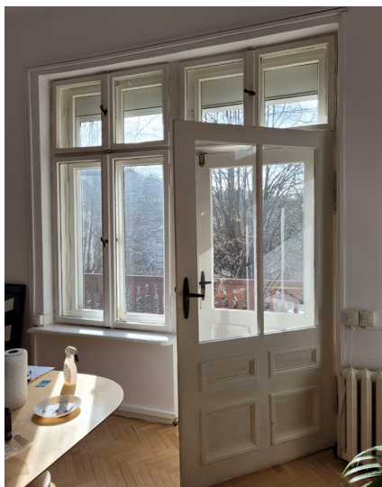
fot. 89. Ościeżce okienne nr 21 (widziane od wewnątrz), wszystkie warstwy malarskie zostały usunięte, stolarkę pomalowano wtórnie na biało. marzec 2021 rok. fot. M. Caban
