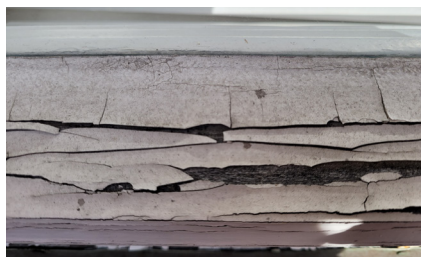
fot. 92, 93. Ościeżce okienne nr 21 Uszkodzone drewniane detale okapników okiennych, silna korozja mikrobiologiczna. marzec 2021 rok. fot. M. Caban
