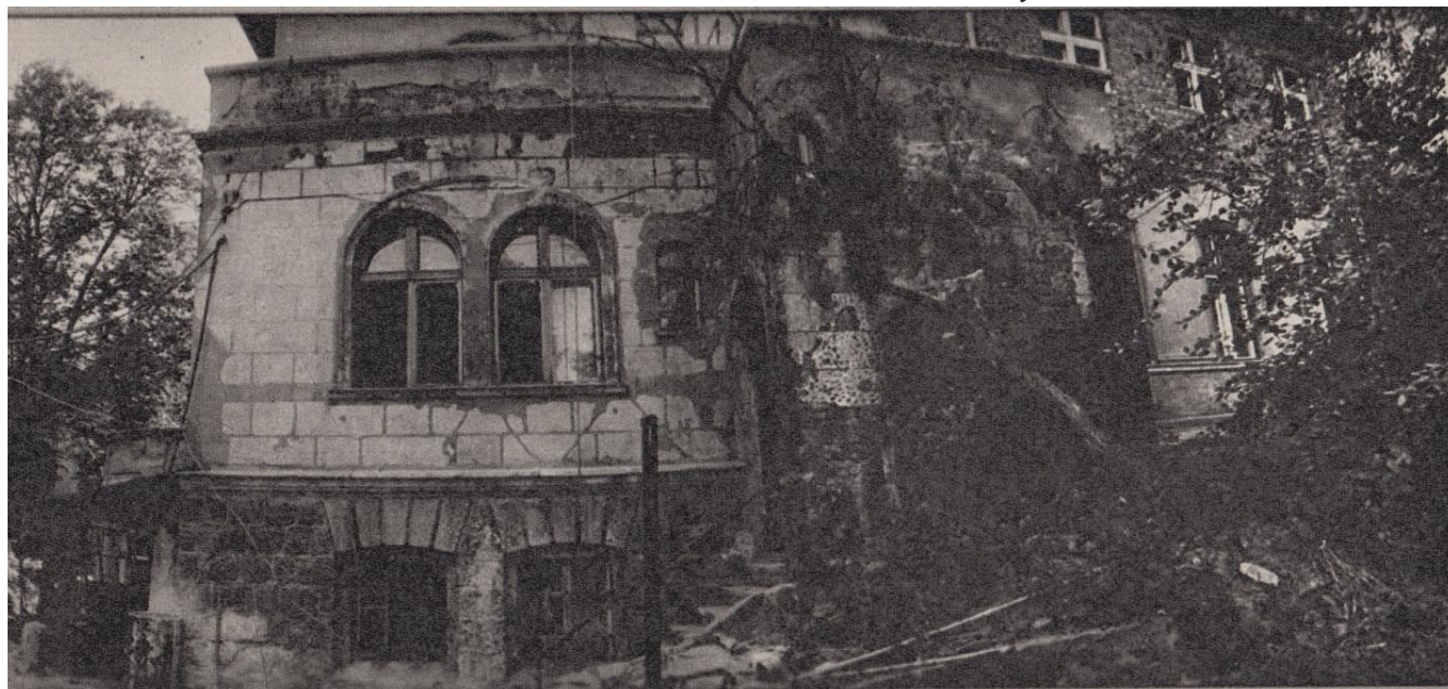
fot. 9. Willa Freymanna w 1979 roku. Widoczne uszkodzenia elewacji. https://images84.fotosik.pl/801/0f32d0c06c23bb27med.jpg
