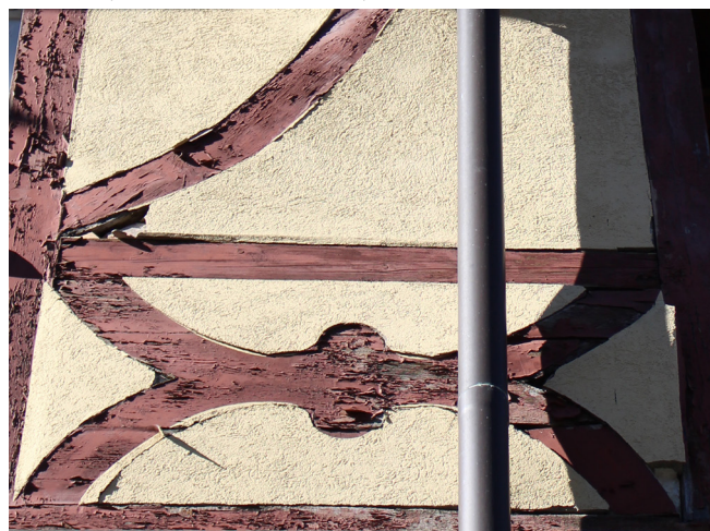
fot. 27. Fragment elewacji szachulcowej z widoczną destrukcją farby oraz tynków, stan 2020 rok. fot. M. Caban
