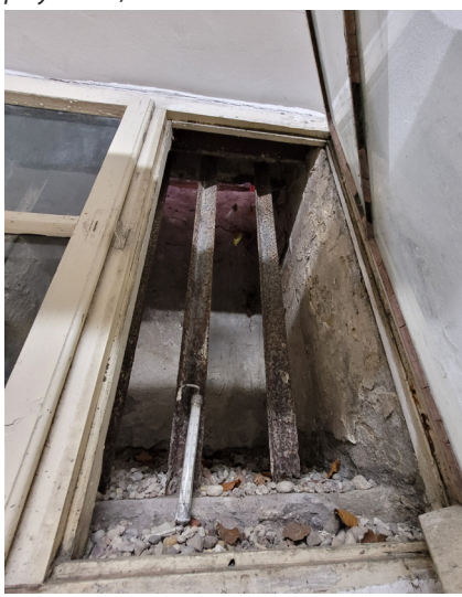
fot. 117. Ościeżce okienne P3 metalowe elementy w naświetlu prawdopodobnie umieszczone wtórnie. Zaleca się ujednolicenie krat w oknach. marzec 2021 rok. fot. M. Caban
