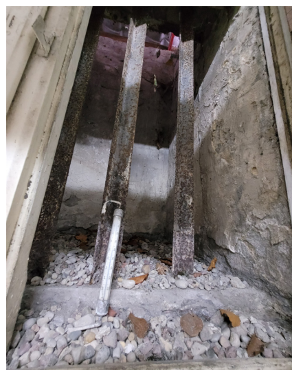
fot. 118. Ościeżce okienne P3 Zniszone ściany naświetla, bardzo silne skażenie mikrobiologiczne wraz z widocznymi wykwitami solnymi. marzec 2021 rok. fot. M. Caban
