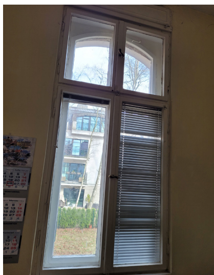
fot. 108. Ościeżce okienne nr 35 (widziane od wewnątrz), wszystkie warstwy malarskie zostały usunięte, stolarkę pomalowano wtórnie na biało. marzec 2021 rok. fot. M. Caban
