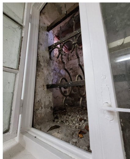
fot. 115. Ościeżce okienne P2 Zniszone ściany naświetla, bardzo silne skażenie mikrobiologiczne wraz z widocznymi wykwitami solnymi. marzec 2021 rok. fot. M. Caban
