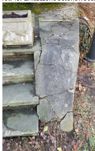
fot. 46. Zniszczone schody wejścia głównego willi.
