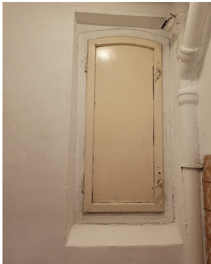
fot. 110. Ościeżce okienne nr P1 (widziane od wewnątrz), stolarka wraz szkleniem pomalowana na biało, okno w bardzo złym stanie - do wymiany, marzec 2021 rok. fot. M. Caban
