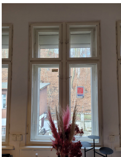
fot. 101. Ościeżce okienne nr 30 (widziane od wewnątrz), wszystkie warstwy malarskie zostały usunięte, stolarkę pomalowano wtórnie na biało. marzec 2021 rok. fot. M. Caban
