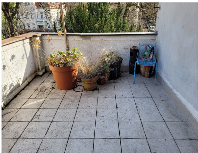
fot. 50. Taras elewacji bocznej, widoczne popękane kafle gresowe oraz skażenie mikrobiologiczne, marzec 2021 rok. fot. M. Caban
