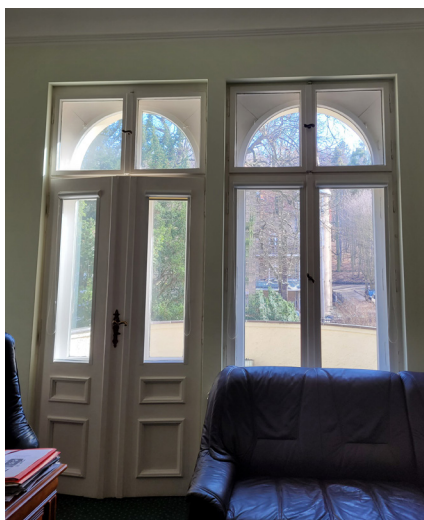
fot. 64. Ościerze okienne i balkonowe nr 6 (widziane od wewnątrz), wszystkie warstwy malarskie zostały usunięte, stolarkę pomalowano wtórnie na biało. marzec 2021 rok. fot. M. Caban
