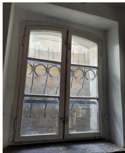
fot. 124. Ościerze okienne P8 stolarka pomalowana na białą, okno w bardzo złym stanie - do wymiany, widoczne oryginalne zapięcia okna (haczyki). marzec 2021 rok. fot. M. Caban
