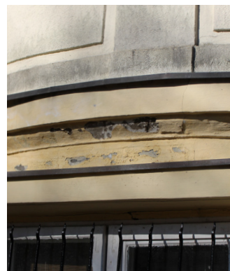
fot. 29. Widoczne zawilgocenie ściany, wykwyty solne, łuszcząca się farba elewacyjna, marzec 2021
