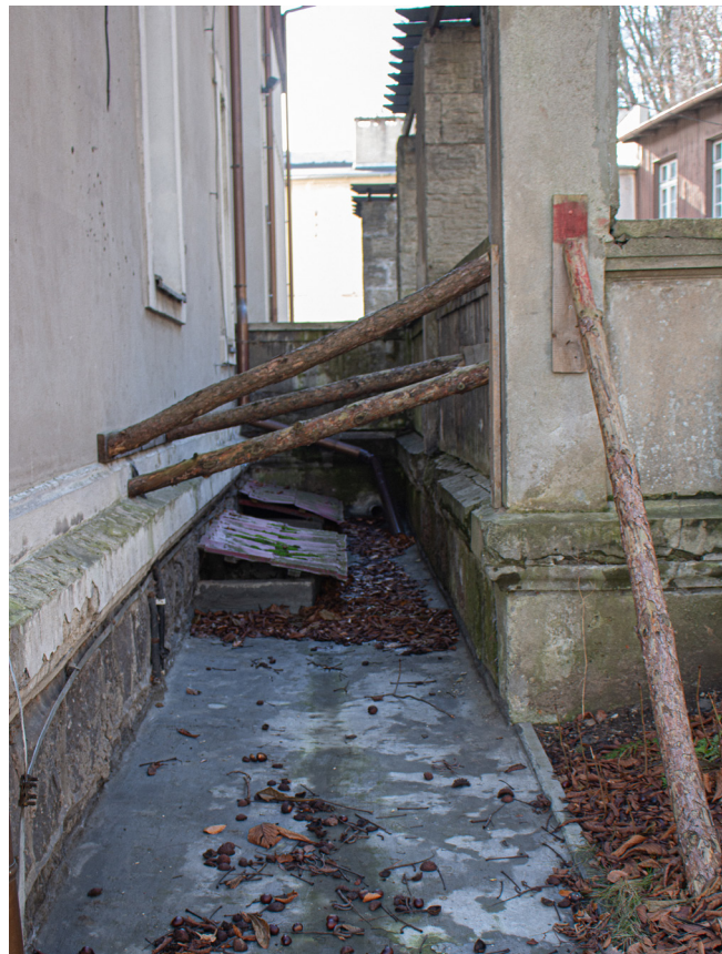
fot. 41. Uszkodzone zadaszenie świetlików kotłowni oraz podstemplowana pergola tarasu, marzec 2021 rok. fot. M. Caban
