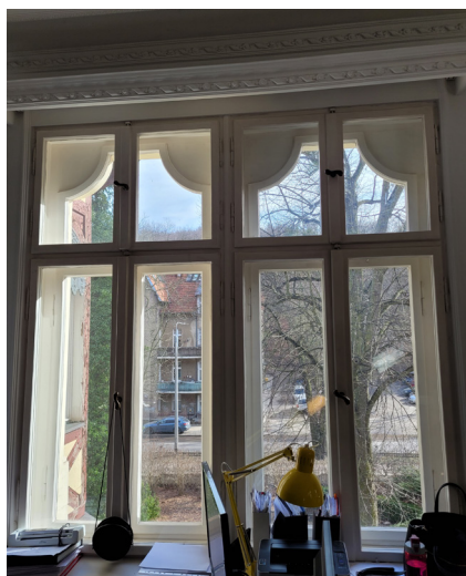
fot. 65. Ościerze okienne nr 7 i 8 (widziane od wewnątrz), wszystkie warstwy malarskie zostały usunięte, stolarkę pomalowano wtórnie na biało. marzec 2021 rok. fot. M. Caban
