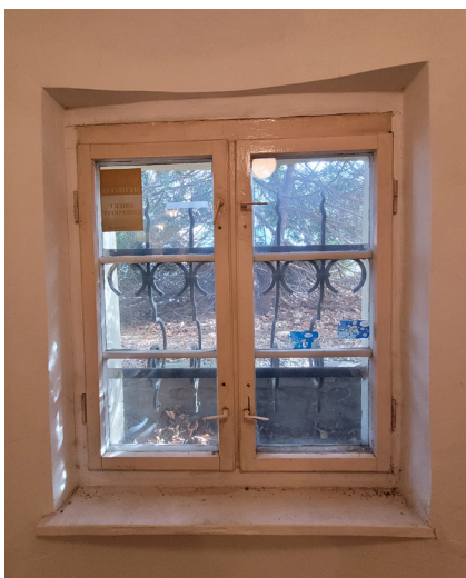
fot. 123. Ościerze okienne P7 (widziane od wewnątrz), stolarka pomalowana na białą, okno w bardzo złym stanie - do wymiany, marzec 2021 rok. fot. M. Caban
