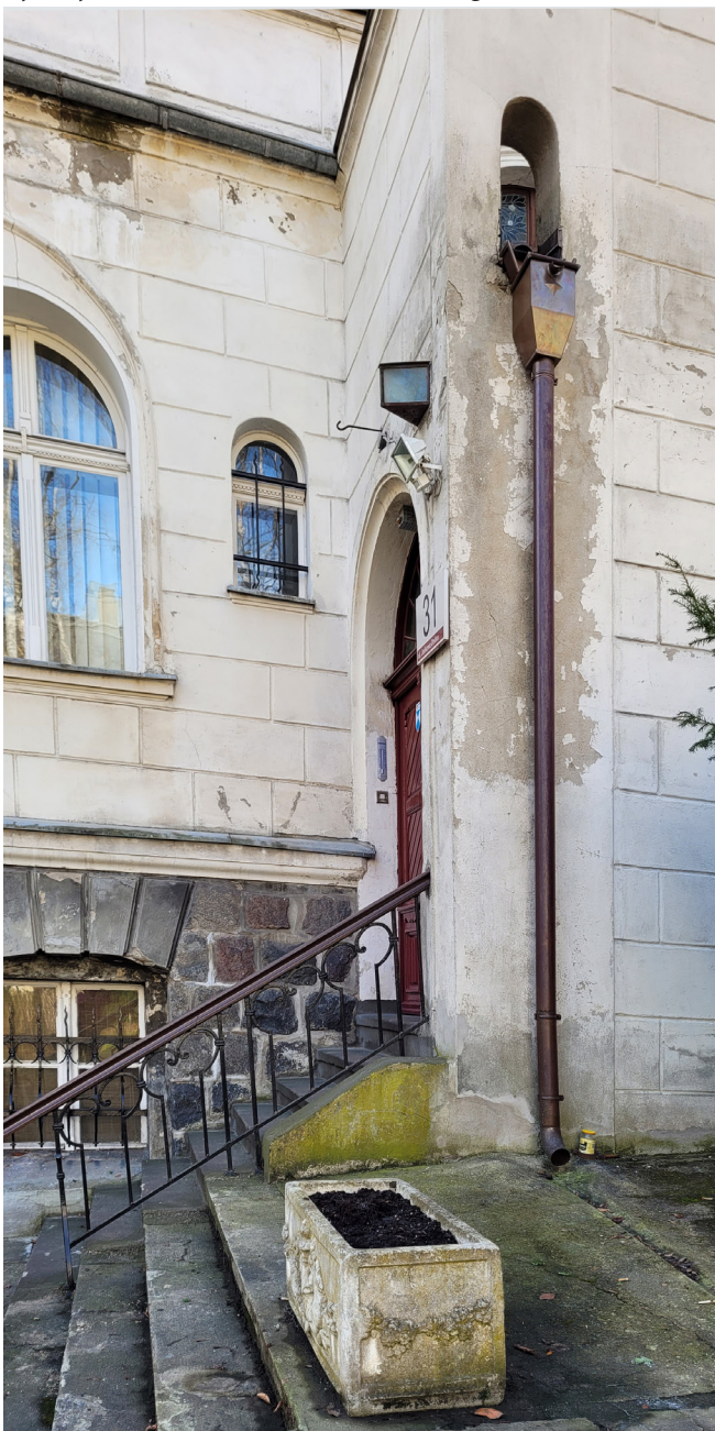
fot. 43. Betonowe schody wejścia głównego, widoczna dezintegracja tynków ściany wzdłuż kosza oraz rury spustowej, marzec 2021, fot. M. Caban
