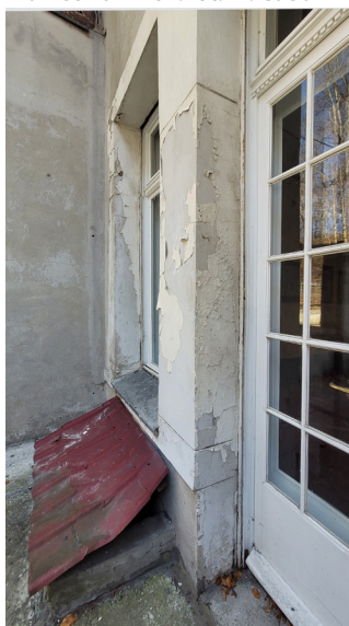
fot. 38. Uszkodzone zadaszenie świetlików kotłowni oraz zdeziintegrowane tynki elewacji.
