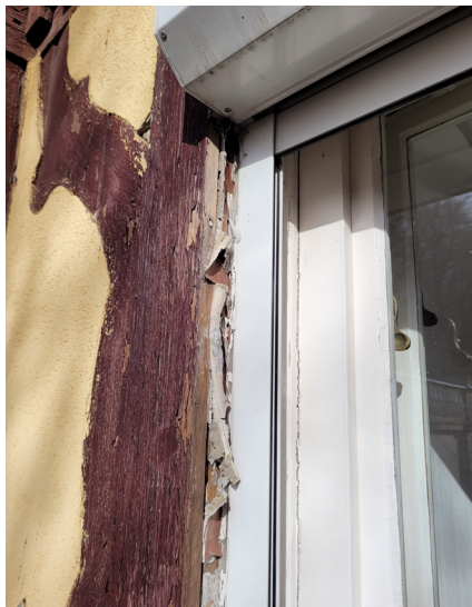
fot. 91. Ościeżce okienne i balkonowe nr 21 (widziane od zewnątrz) widoczny montaż rolet antywłamaniowych oraz łuszczące się farby elewacji i detalu drewnianego. marzec 2021 rok. fot. M. Caban
