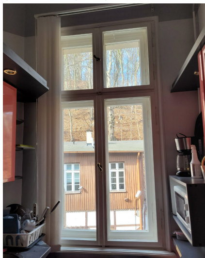
fot. 98. Ościeżce okienne nr 32 (widziane od wewnątrz), wszystkie warstwy malarskie zostały usunięte, stolarkę pomalowano wtórnie na biało. marzec 2021 rok. fot. M. Caban
