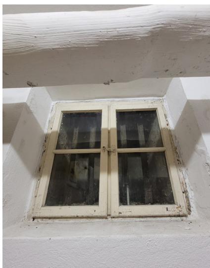
fot. 116. Ościeżce okienne P3 (widziane od wewnątrz), stolarka pomalowana na biało, okno w bardzo złym stanie - do wymiany, marzec 2021 rok. fot. M. Caban
