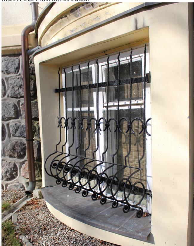
fot. 25. Okno frontowe strefy przyziemia, wtórna krata wykonana z prętów zbrojeniowych formą przypominającą oryginalne kute ze stali, marzec 2021 rok. fot. M. Caban
