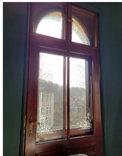
fot. 97. Ościeżce balkonowe nr 23 (widziane od wewnątrz), wszystkie warstwy malarskie zostały usunięte, stolarkę pomalowano lakierobejcą. marzec 2021 rok. fot. M. Caban
