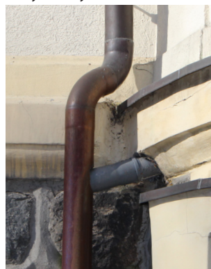
fot. 28. Tymczasowy odpływ wody opadowej z tarasu frontowego, marzec 2021.
