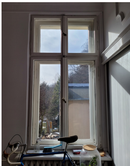
fot. 95. Ościeżce okienne nr 18 (widziane od wewnątrz), wszystkie warstwy malarskie zostały usunięte, stolarkę pomalowano wtórnie na biało. marzec 2021 rok. fot. M. Caban
