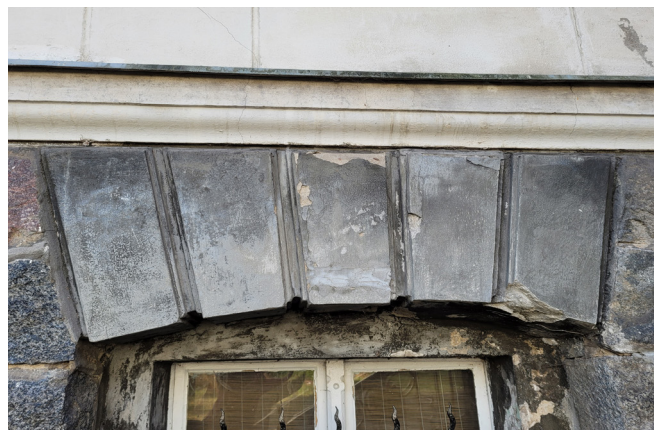
fot. 44. Wykwity solne oraz silne skażenie mikrobiologiczne doprowadziły do zniszczeń elewacji, marzec 2021 rok. fot. M. Caban
