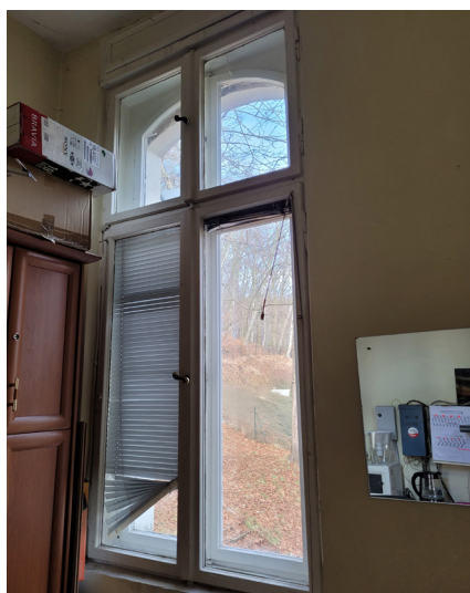
fot. 107. Ościeżce okienne nr 37 (widziane od wewnątrz), wszystkie warstwy malarskie zostały usunięte, stolarkę pomalowano wtórnie na biało. marzec 2021 rok. fot. M. Caban
