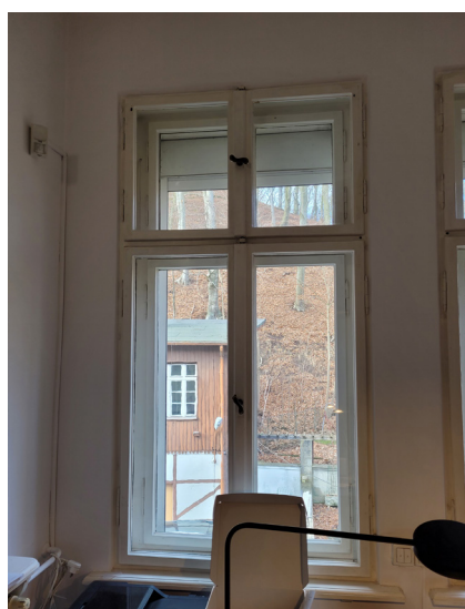
fot. 102. Ościeżce okienne nr 31 (widziane od wewnątrz), wszystkie warstwy malarskie zostały usunięte, stolarkę pomalowano wtórnie na biało. marzec 2021 rok. fot. M. Caban
