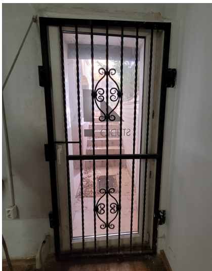
fot. 126. Ościerze drzwiowe nr P10 Skrzydło drzwi oraz ościeże zostały wymienione na plastikowe w białym kolorze, należy ujednolicić estetycznie. marzec 2021 rok. fot. M. Caban
