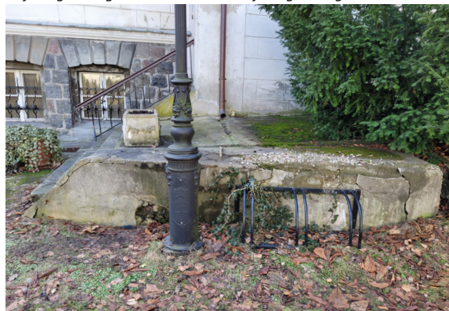
fot. 48. Zniszczone schody wejścia głównego. fot. M. Caban
