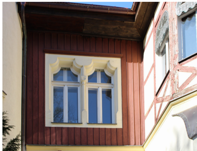
fot. 26. Okna elewacji frontowej pierwszego piętra, widoczne wtórne odeszkowanie oraz brak oryginalnych metalowych zdobień znajdujących się pierwotnie u szczytu gładzi marzec 2021 rok.
