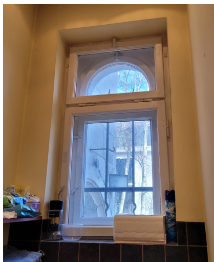
fot. 105. Ościeżce okienne nr 34 (widziane od wewnątrz), wszystkie warstwy malarskie zostały usunięte, stolarkę pomalowano wtórnie na biało. marzec 2021 rok. fot. M. Caban
