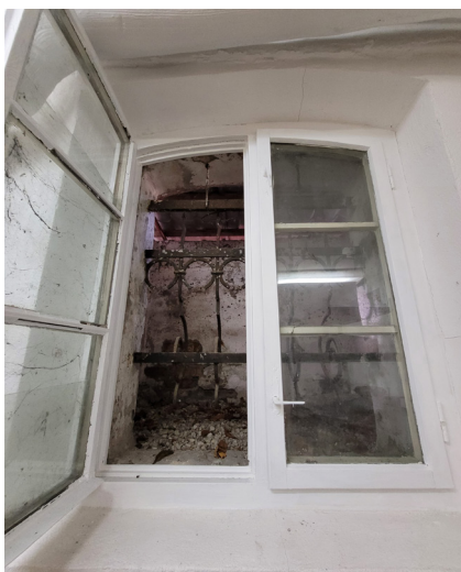
fot. 114. Ościeżce okienne P2 naświetle - oryginalna kuta krata, jej forma powinna posłużyć jako wzór do rekonstrukcji brakujących krat okien przyziemia, marzec 2021 rok. fot. M. Caban
