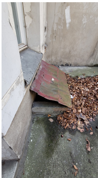
fot. 39. Uszkodzone zadaszenie świetlików kotłowni oraz zdeziintegrowane tynki elewacji.
