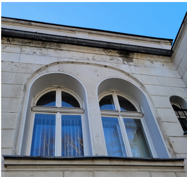
fot. 42. Zawilgocenie ściany, spowodowało dezintegrację tynku, wykwity solne oraz silne skażenie mikrobiologiczne.
