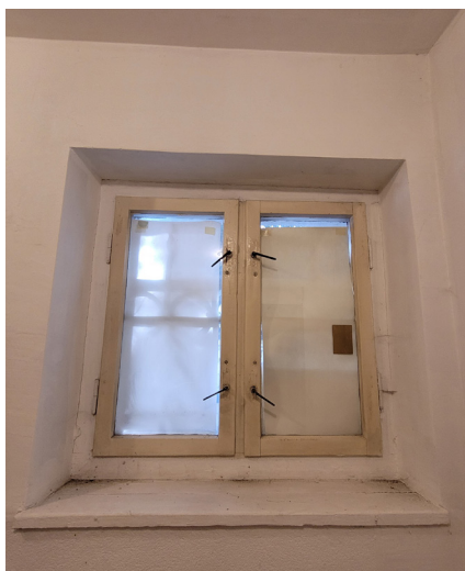
fot. 122. Ościerze okienne P6 (widziane od wewnątrz), stolarka pomalowana na białą, okno w bardzo złym stanie - do wymiany, marzec 2021 rok. fot. M. Caban
