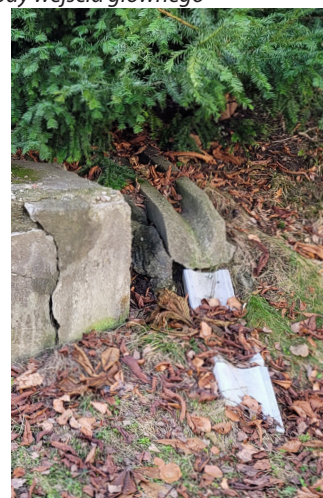
fot. 47. Zniszczone schody wejścia głównego willi.
