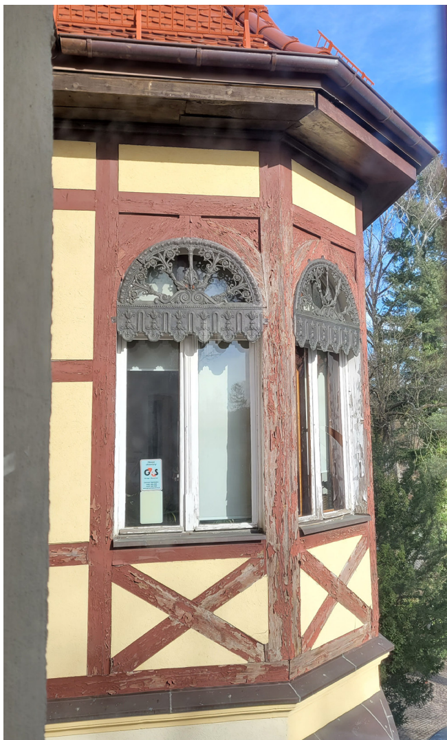
fot. 24. Wykusz szachulcowy. Widoczna destrukcja farby pokrywającej drewno oraz zniszczone okapniki stolarki okiennej, marzec 2021 rok. fot. M. Caban
