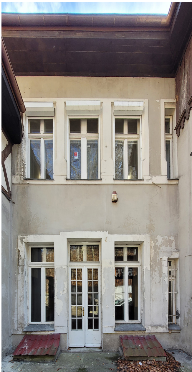
fot. 37. Zawilgocenie tylnej ściany elewacji willi, wynikające prawdopodobnie z podciągania kapilarnego oraz zaciekania wody opadowej, co spowodowało dezintegrację tynku, wykwity solne, złuszczenie się farb oraz silne skażenie mikrobiologiczne, marzec 2021 rok. fot. M. Caban
