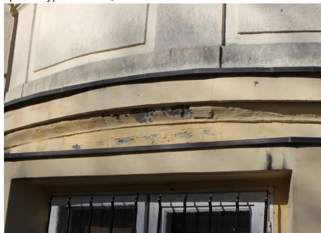
fot. 54. Taras elewacji frontowej, widoczna dezintegracja tynku, wykwit solny, złuszczenie się farb oraz silne skażenie mikrobiologiczne, marzec 2021 rok. fot. M. Caban
