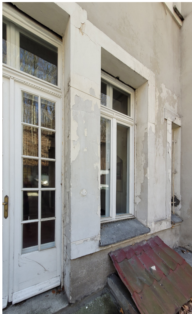
fot. 40. Widoczne, wykwity solne, łuszczące się farby oraz skażenie mikrobiologiczne oraz zniszczone metalowe parapety. marzec 2021 rok. fot. M. Caban
