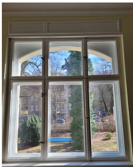
fot. 55. Ościeżce okienne nr 3 (widziane od wewnątrz), wszystkie warstwy malarskie zostały usunięte, stolarkę pomalowano wtórnie na biało. marzec 2021 rok. fot. M. Caban
