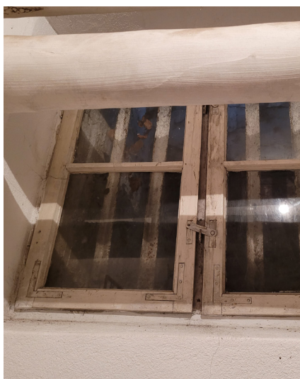
fot. 125. Ościerze okienne P9 (widziane od wewnątrz), stolarka pomalowana na białą, okno w bardzo złym stanie - do wymiany, marzec 2021 rok. fot. M. Caban
