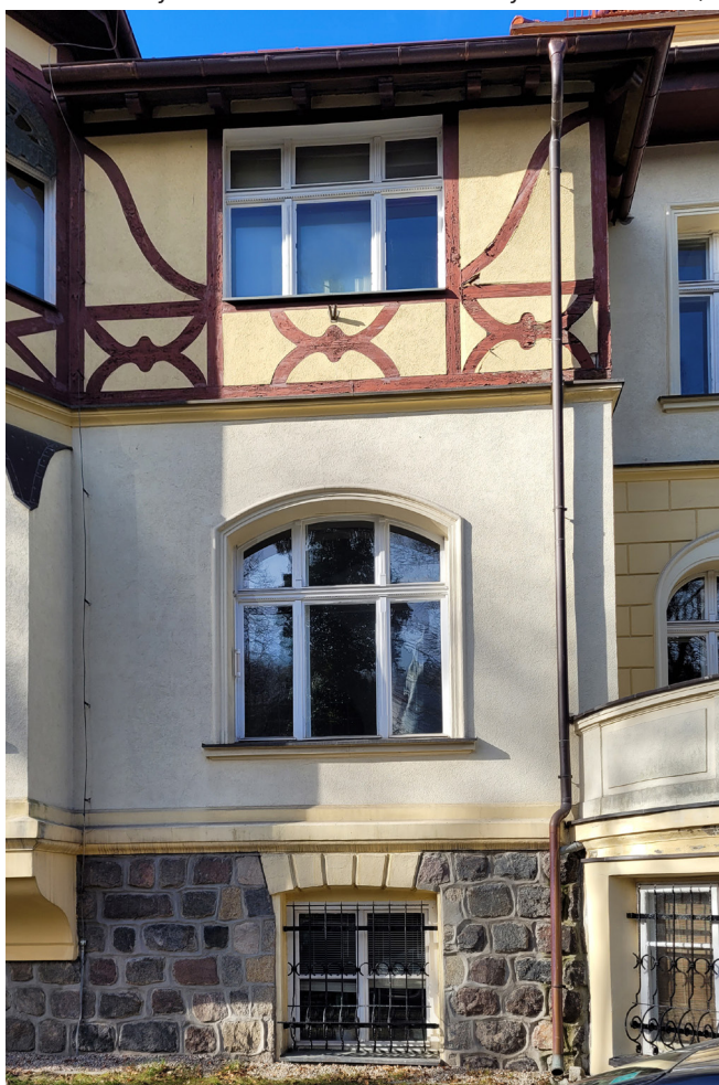
fot. 11. Elewacja frontowa - widoczne wtórne kraty okien strefy przyziemia (wykonane z prętów wzorem naśladujące oryginalne kute). fot. M. Caban, marzec 2021
