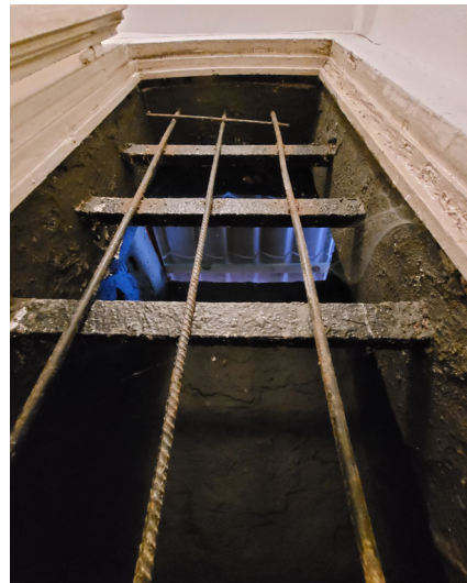
fot. 112. Ościeżce okienne nr P1 Zniszone ściany naświetla, bardzo silne skażenie mikrobiologiczne wraz z widocznymi wykwitami solnymi. marzec 2021 rok. fot. M. Caban
