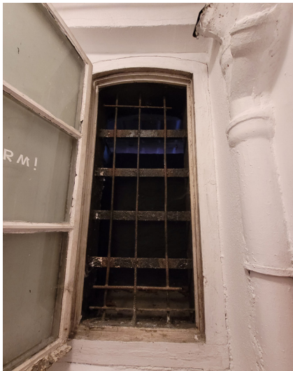
fot. 111. Ościeżce okienne nr P1 naświetle - płaskowniki prawdopodobnie oryginalne, pręty pionowe kraty dodane wtórnie, ze względów bezpieczeństwa. marzec 2021 rok. fot. M. Caban
