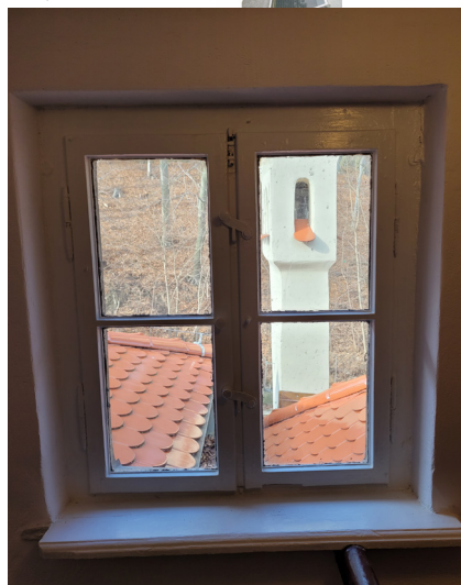
fot. 99. Ościeżce okienne nr 33 (widziane od wewnątrz), wszystkie warstwy malarskie zostały usunięte, stolarkę pomalowano wtórnie na biało. marzec 2021 rok. fot. M. Caban
