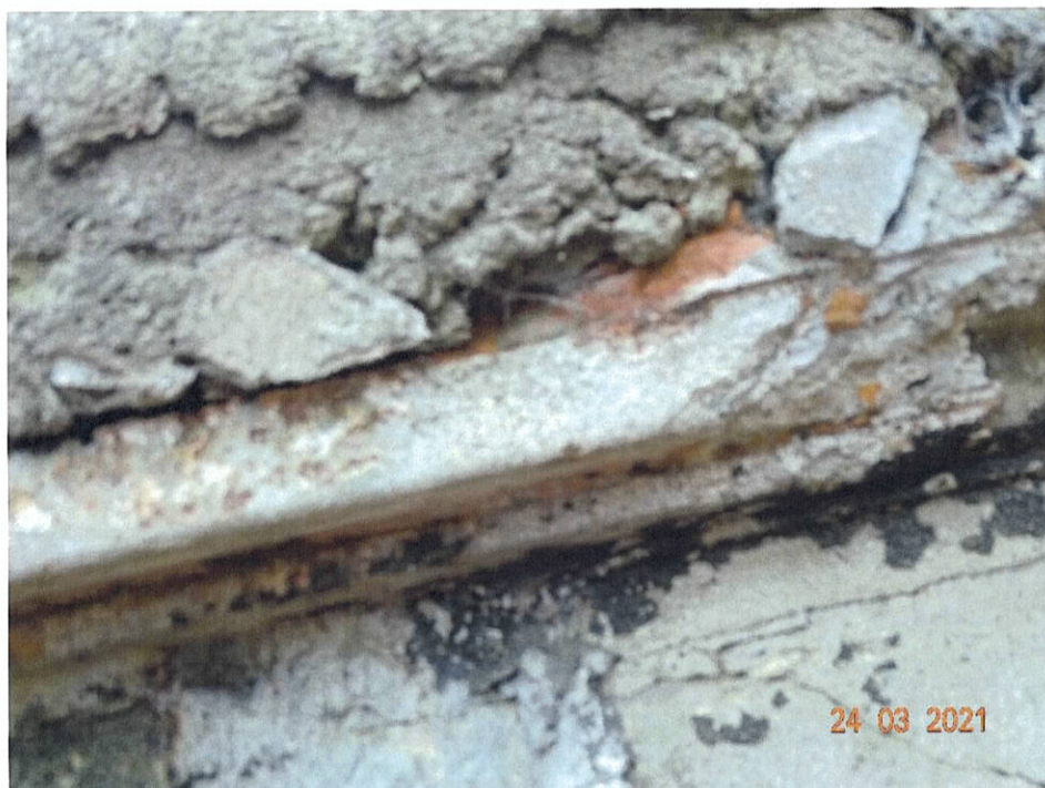
Zbliżenie gzymsu okapowego w miejscu ubytku wykończenia z tynku
