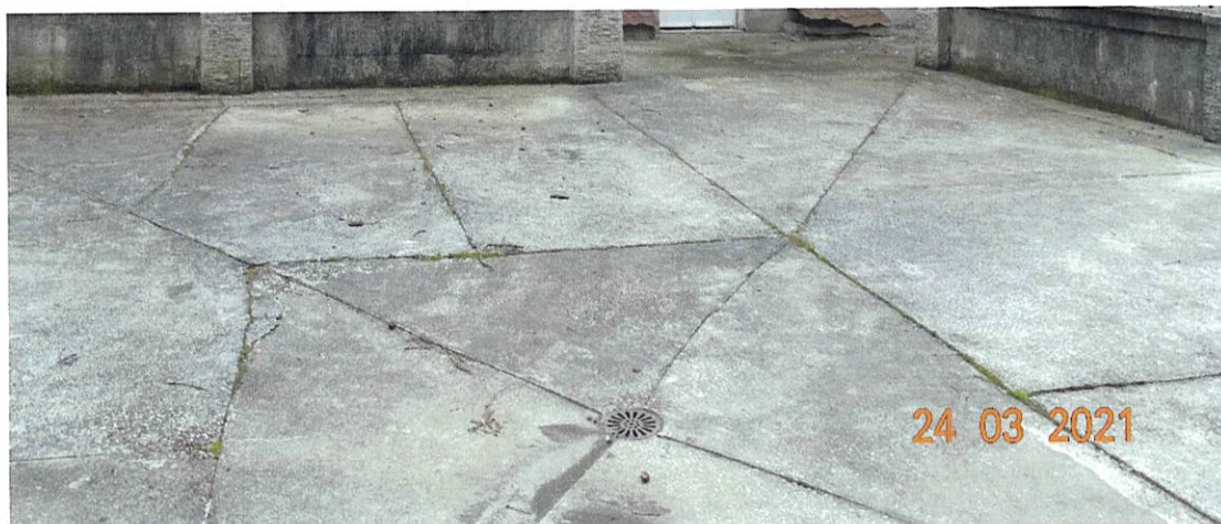
Widok opisanych powyżej uszkodzeń płyty posadzki tarasu
