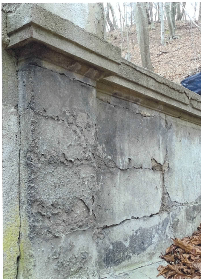
Zarysowania i niewielkie spękania muru obwodowego tarasu
