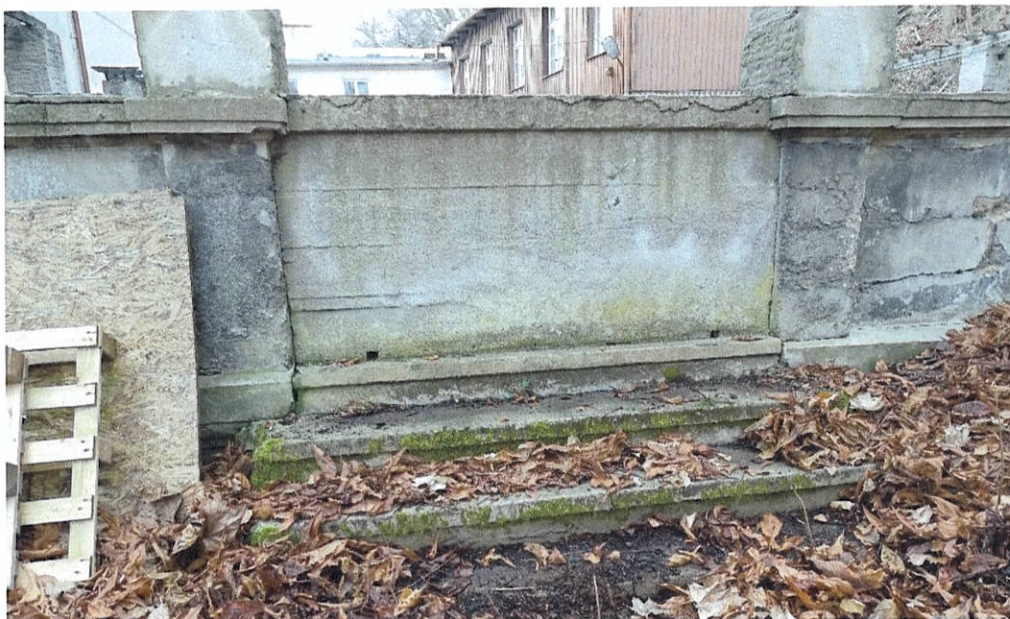
Widok zamurowanego wejścia na taras od ogrodu
