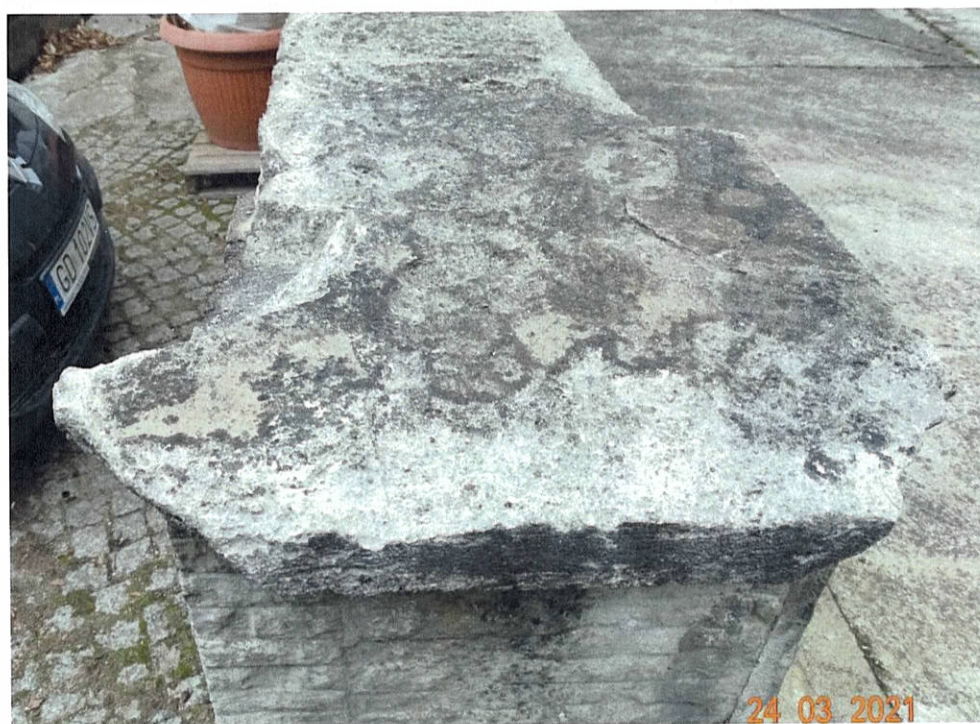
Ubytki górnego gzymsu muru obwodowego tarasu
