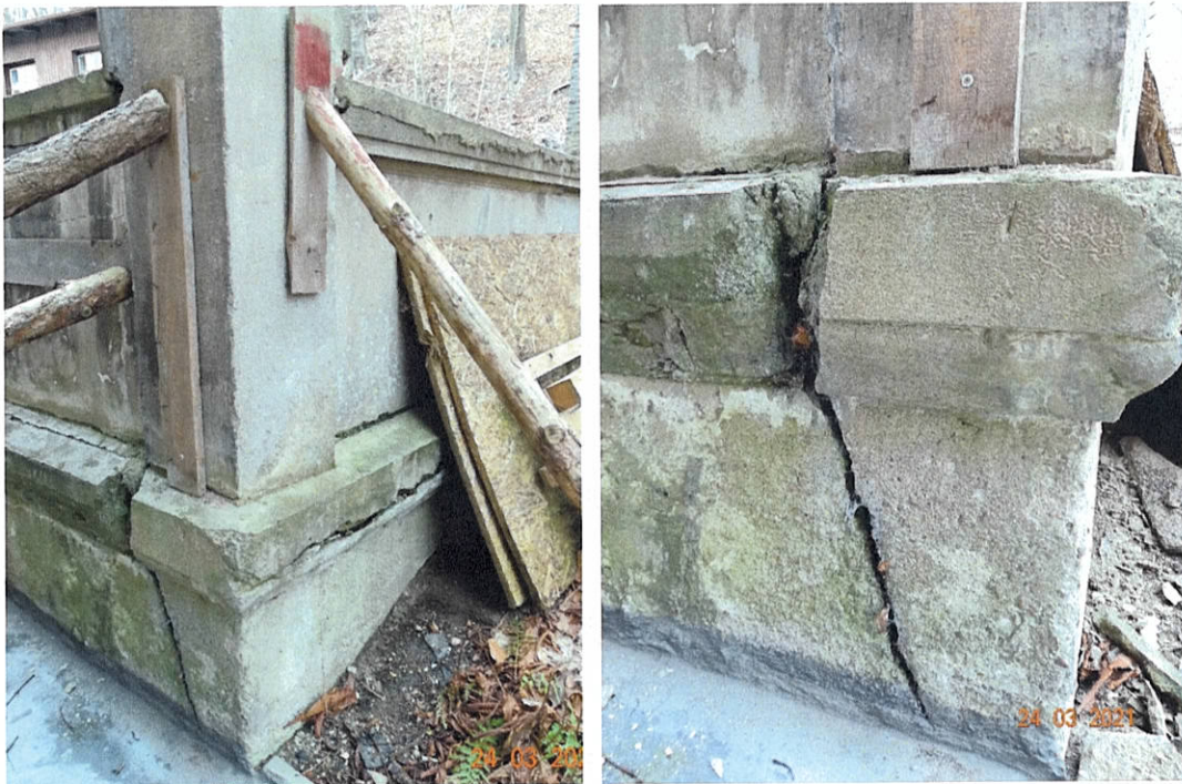
Widok uszkodzonego pld.-wsch. narożnika tarasu
