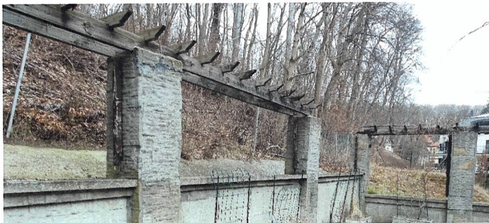
Widok zdekompletowanych pergoli w płn.-wsch. narożniku tarasu
