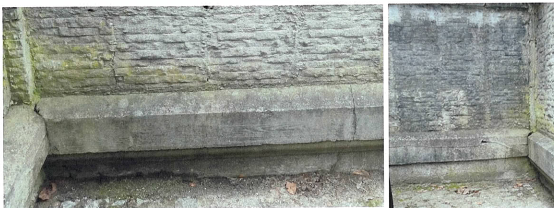
Widok zarysowania dolnego gzymsu muru obwodowego i porostu glonów
